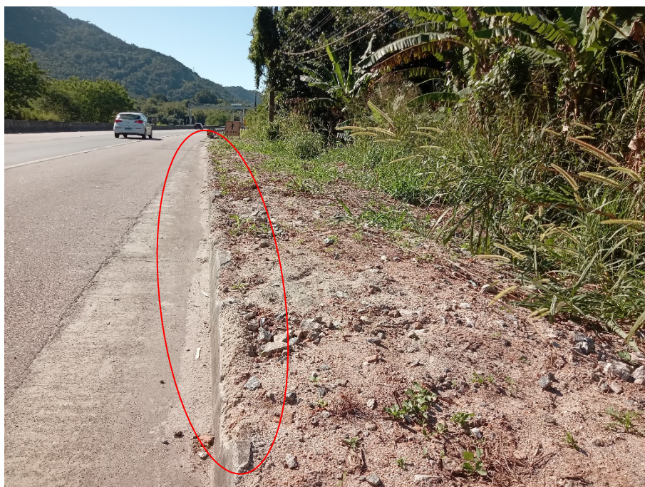
Foto 6: Meio fio danificado por máquina no processo de escavação de vala.
