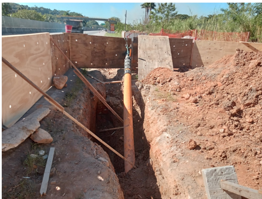
Foto 13: Tubulação que recebeu a passagem de PIG.
