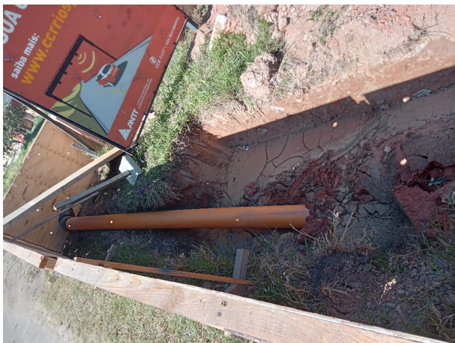
Foto 14: Tubulação que será removida devido rompimento da cabeça puxada.
