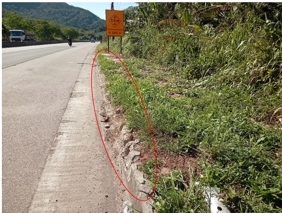
Foto 5: Meio fio danificado por máquina no processo de escavação.
