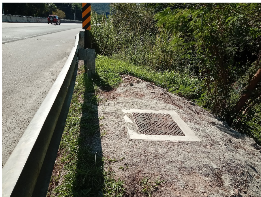
Foto 2: Caixa de válvula de rede a montante da ponte (travessia aérea ser realizada).
