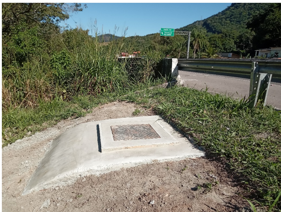
Foto 4: Caixa de válvula a jusante da ponte sobre o Rio Itinguçu.
