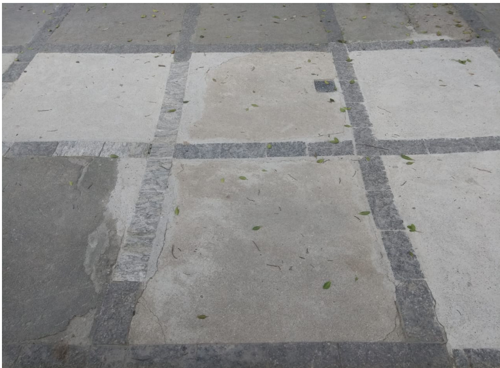
Foto 14: Afundamento na recomposição, em frente ao imóvel nº 108.
