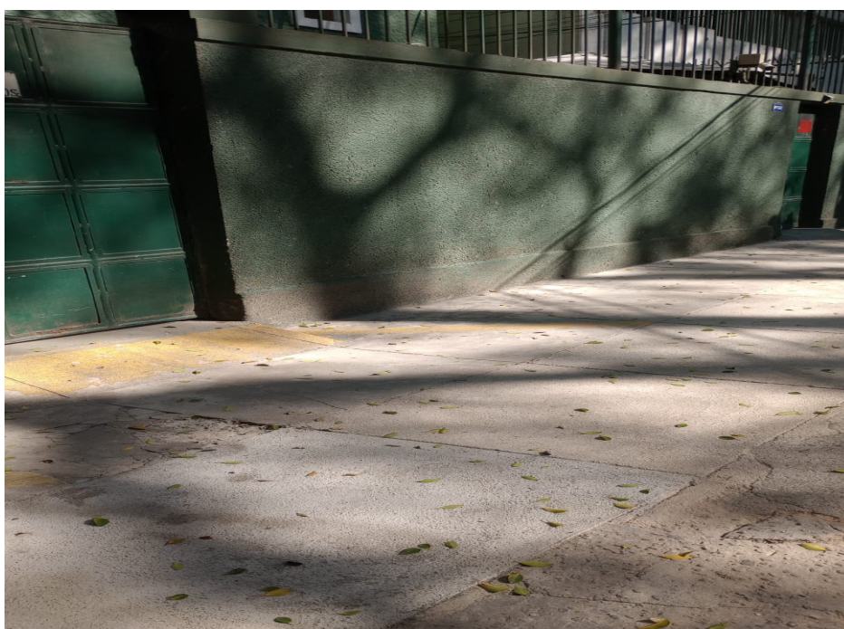
Foto 26: Conserto da fenda na recomposição, em frente ao imóvel nº 133.
