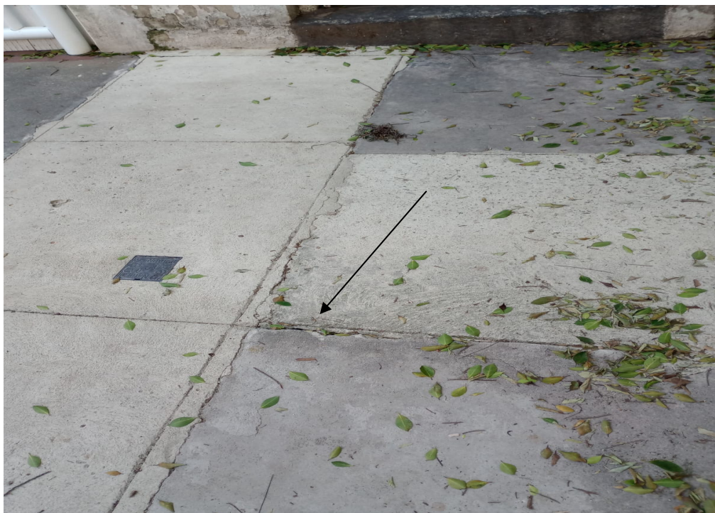
Foto 9: Buraco na imenda da recomposição com o piso original, em frente ao imóvel nº 172.
