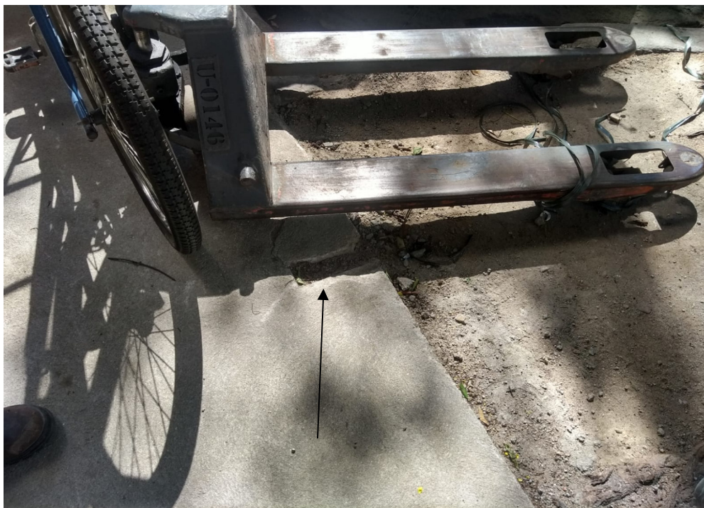
Foto 3: Buraco na recomposição, em frente ao imóvel nº 01.
