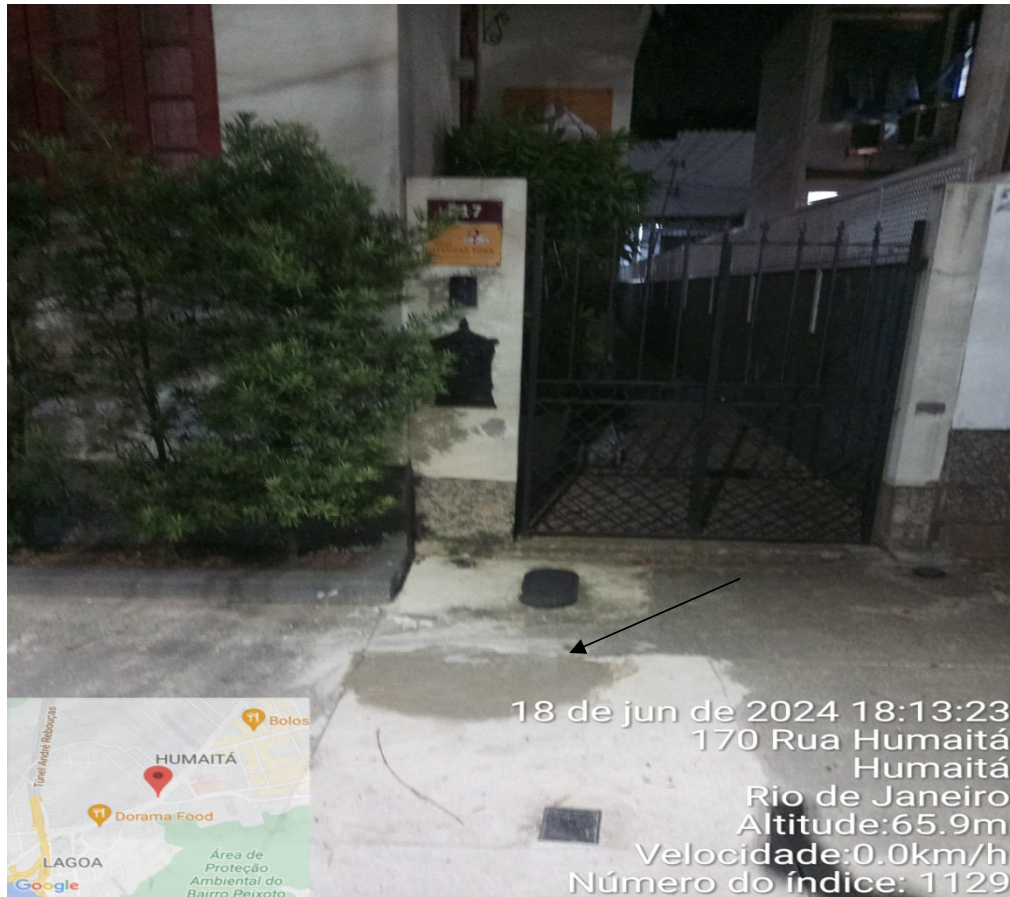
Foto 29: Conserto da fenda na recomposição, em frente ao imóvel nº 217.
