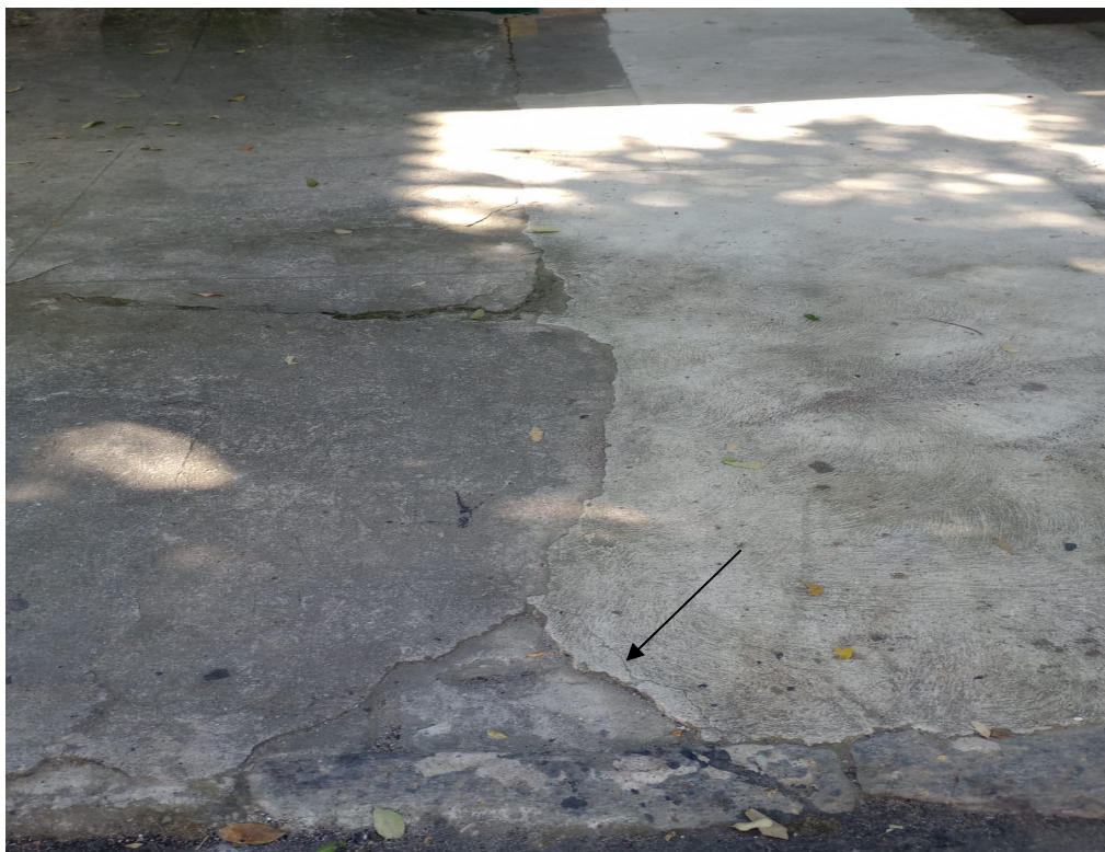
Foto 11: Buraco na imenda da recomposição com o piso original, em frente ao imóvel nº 226.
