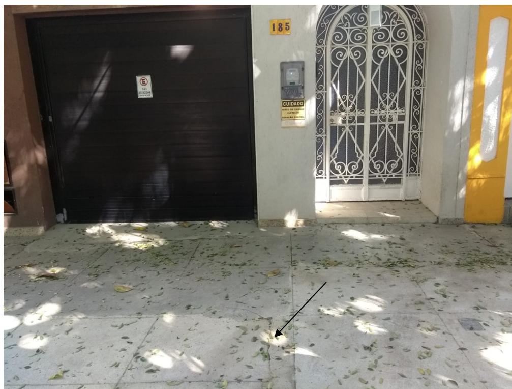
Foto 10: Fenda na recomposição, em frente ao imóvel nº 185.
