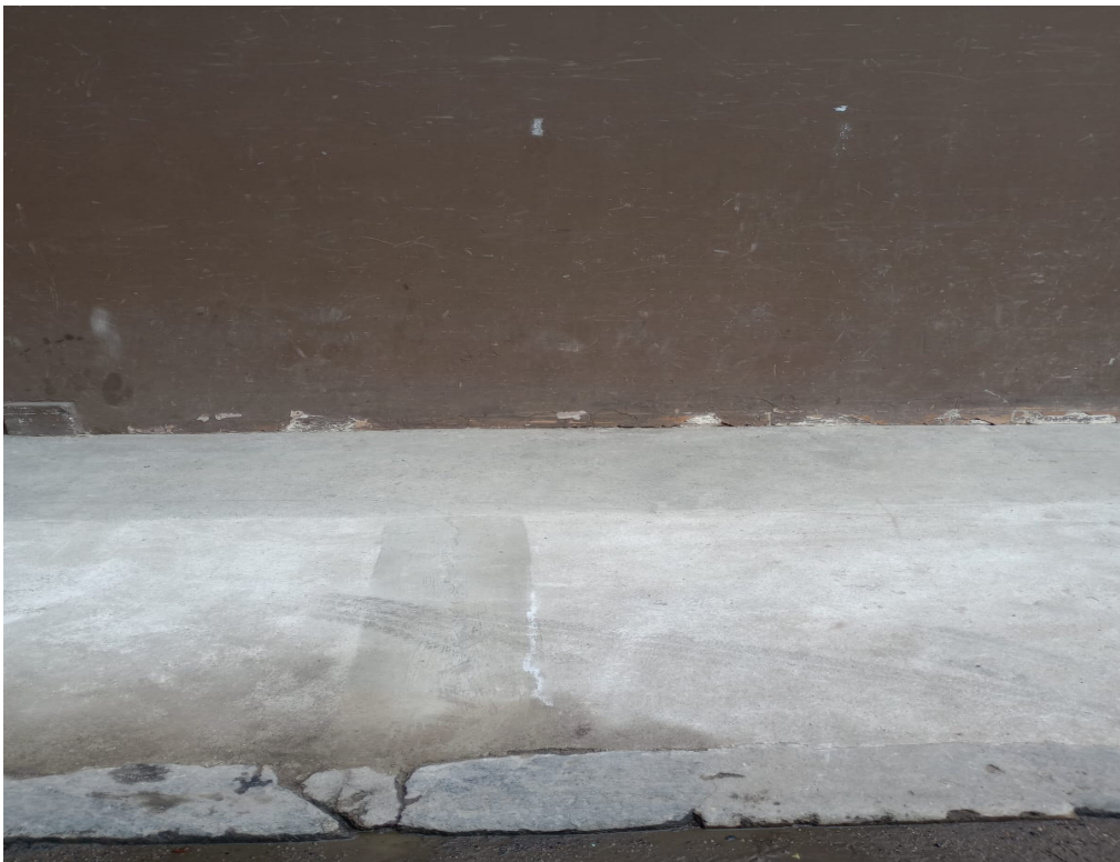
Foto 18: Conserto da fenda na recomposição, em frente ao imóvel nº 01.
