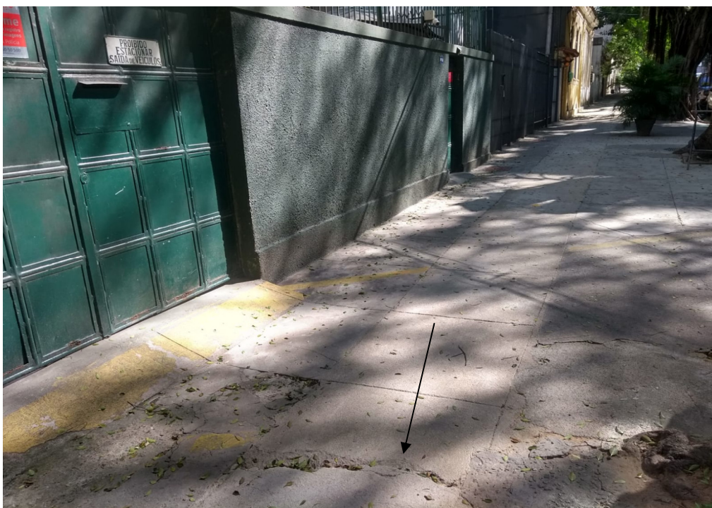
Foto 12: Fenda na recomposição, em frente ao imóvel nº 133.
