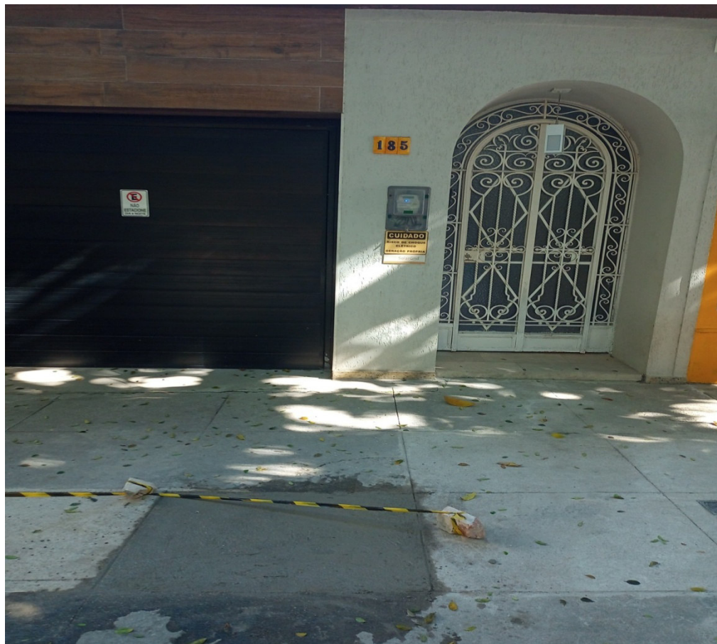
Foto 24: Conserto da fenda na recomposição, em frente ao imóvel nº 185.
