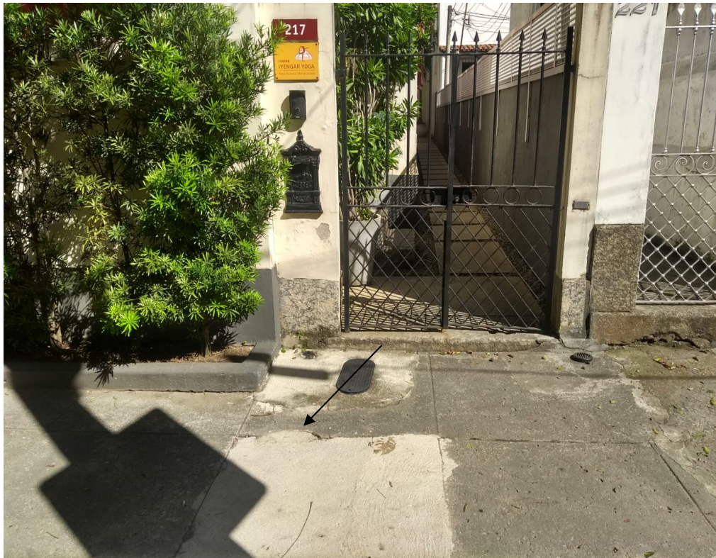
Foto 15: Fenda na recomposição, em frente ao imóvel nº 217.
