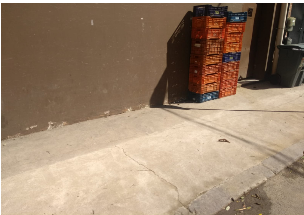
Foto 4: Fenda na recomposição, em frente ao imóvel nº 01.
