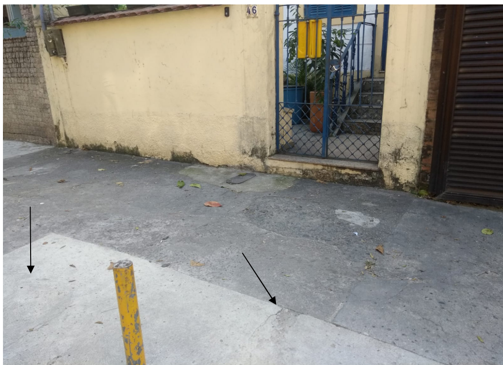
Foto 5: Afundamento na recomposição, em frente ao imóvel nº 46.
