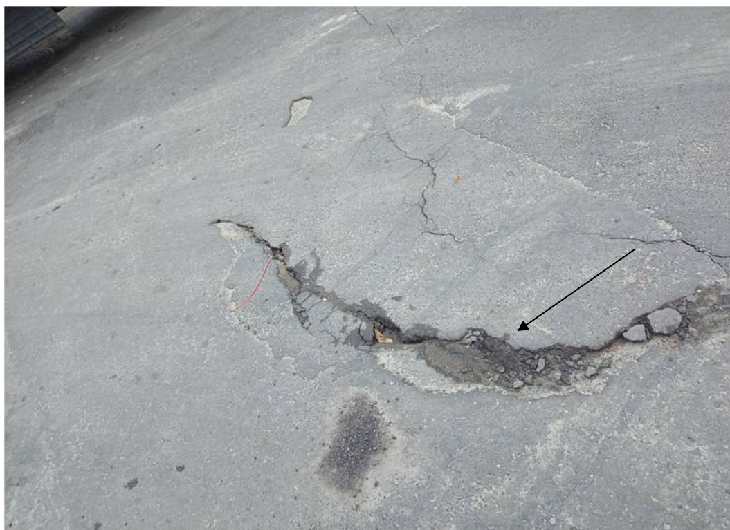
Foto 32: Buracos recorrentes na recomposição, na esquina da Rua Maria Eugênia, fotos do relatório.
