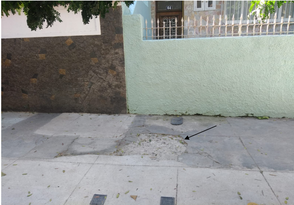
Foto 13: Piso original junto à obra danificada, em frente ao imóvel nº 64.
