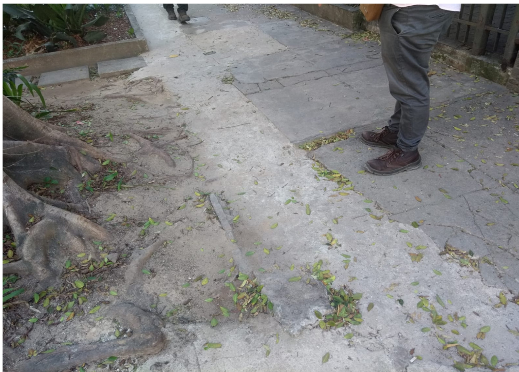
Foto 7: Buraco na imenda da recomposição com o piso original, em frente ao imóvel nº 90.
