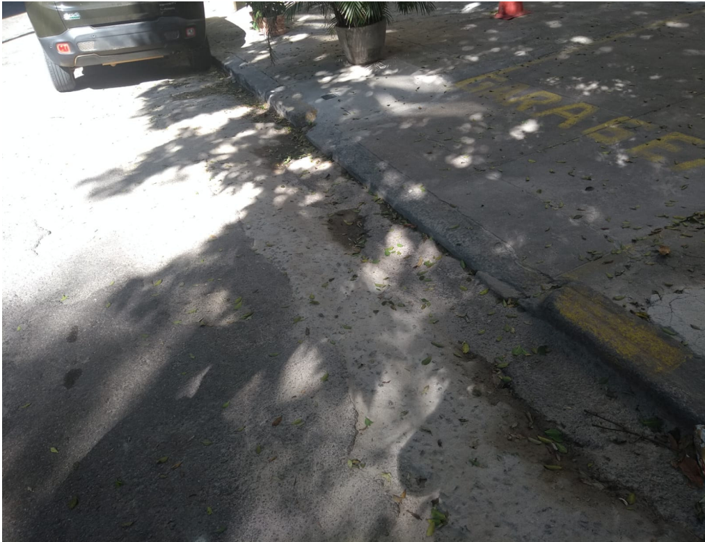
Foto 1: Recomposição provisória na via sem sinalização.
