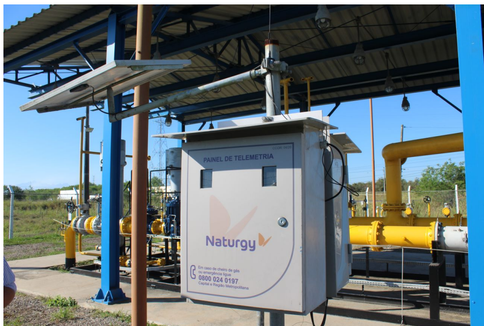
Foto 8: Painel de telemetria.
