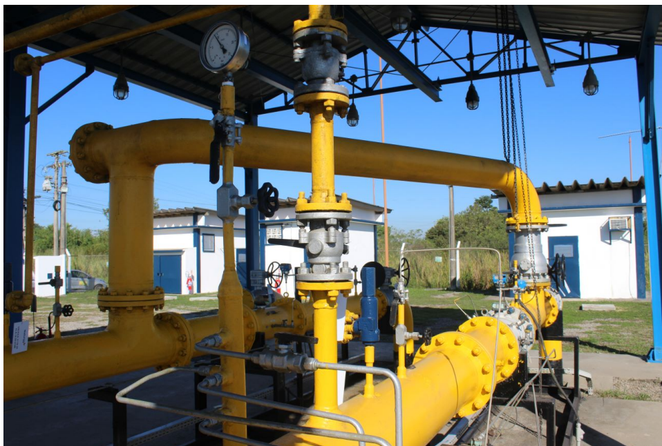
Foto 5: Tubulação de entrada e saída de gás natural.
