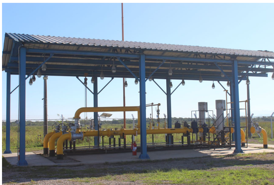
Foto 4: Tubulação de saída a jusante à medição.
