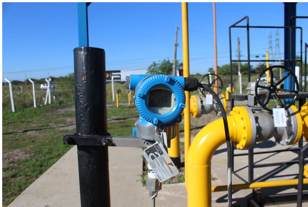
Foto 7: Medidor de vazão da turbina.
