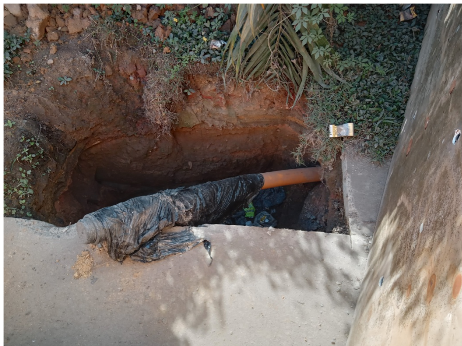
Foto 8: Ponta de rede capeada PE \varnothing 90 mm.
