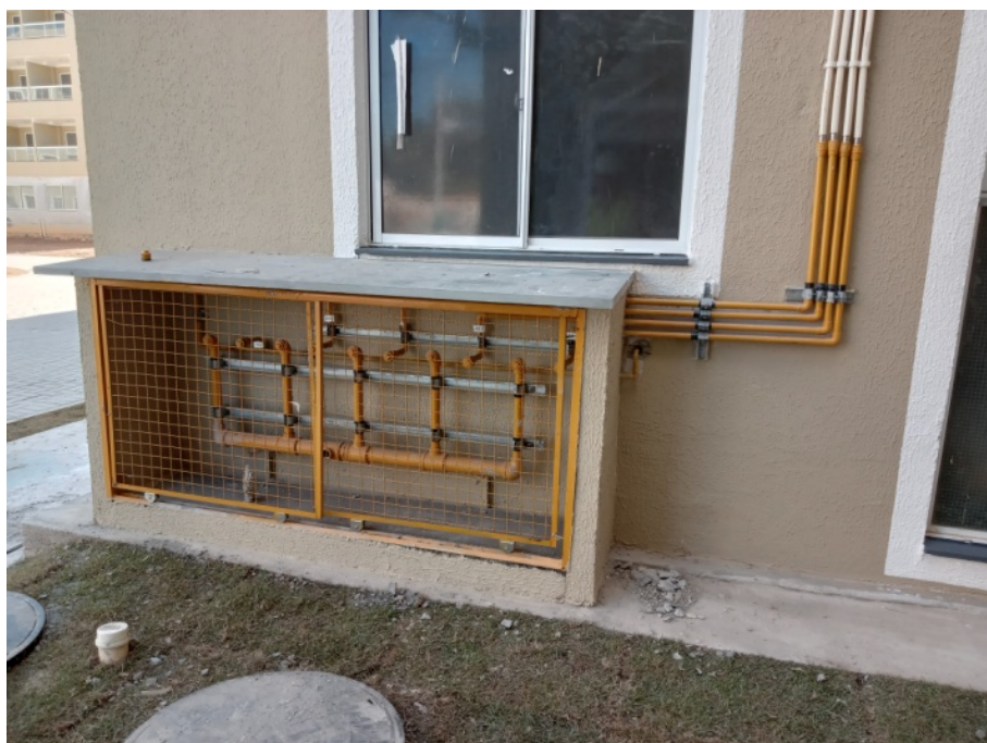
Foto 8: Cabine de medidores e prumada da rede interna.
