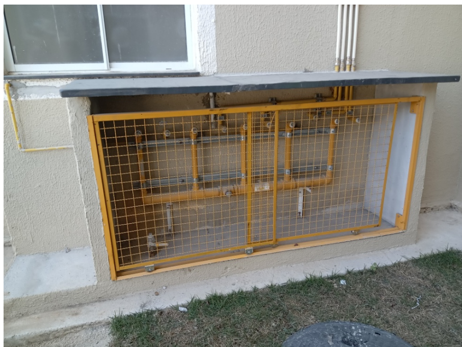
Foto 4: Abrigo de medidores.
