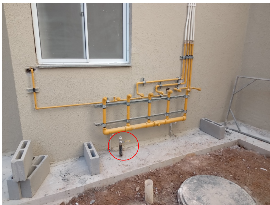
Foto 7: Medida ao alto e válvula de ramal.
