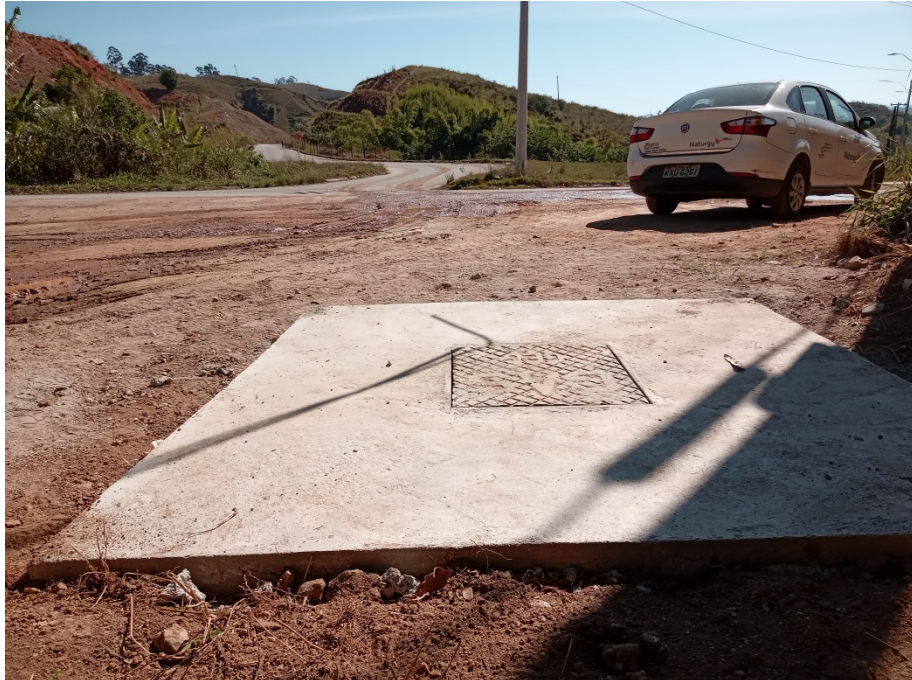
Foto 1: Caixa de válvula de rede próxima ao ponto de interligação de rede existente.
