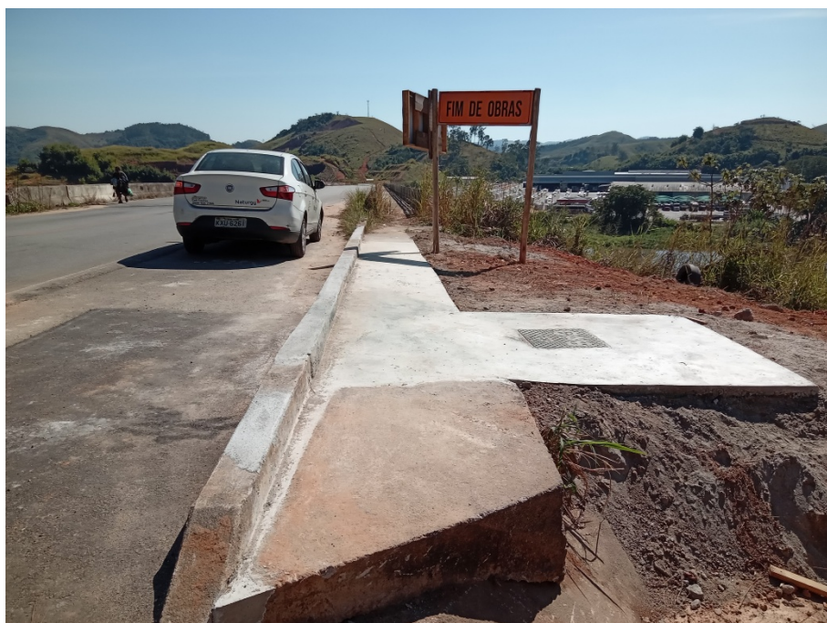
Foto 8: Caixa de válvula de rede a montante do elevado.
