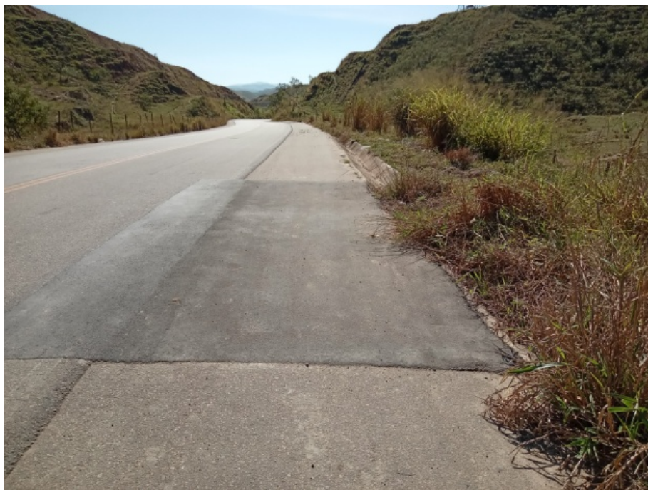
Foto 5: Ausência de pintura da linha de bordo.
