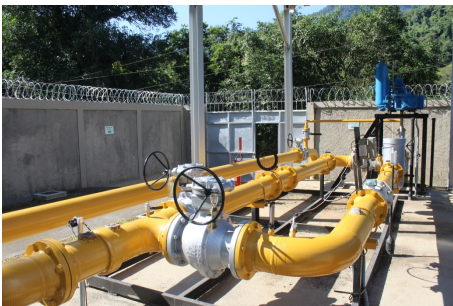
Foto 4: Tubulação de saída a jusante à medição.
