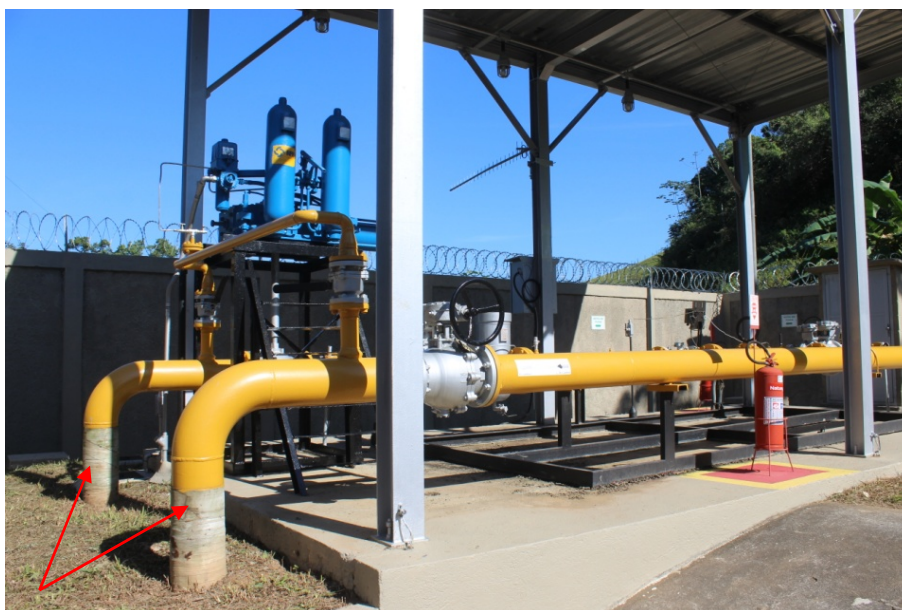
Foto 9: Tubulação de entrada e saída de gás natural.
