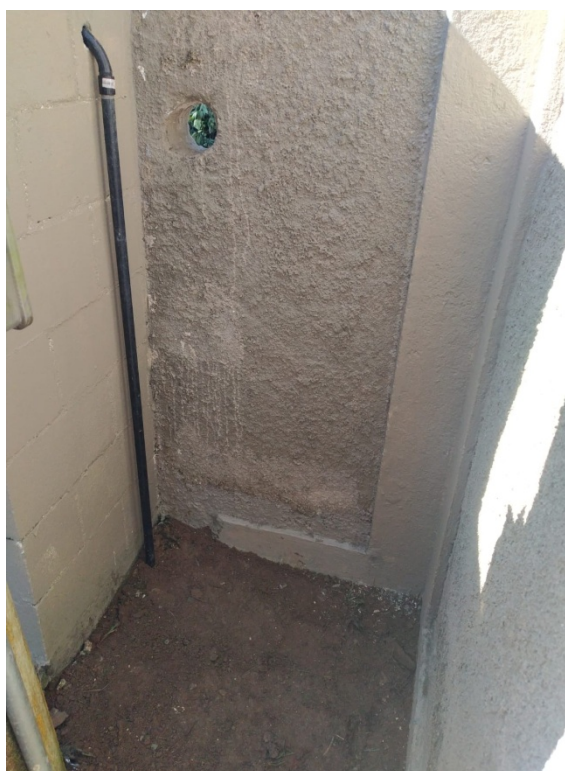
Foto 12: Adequação da proteção mecânica do condutor elétrico.
