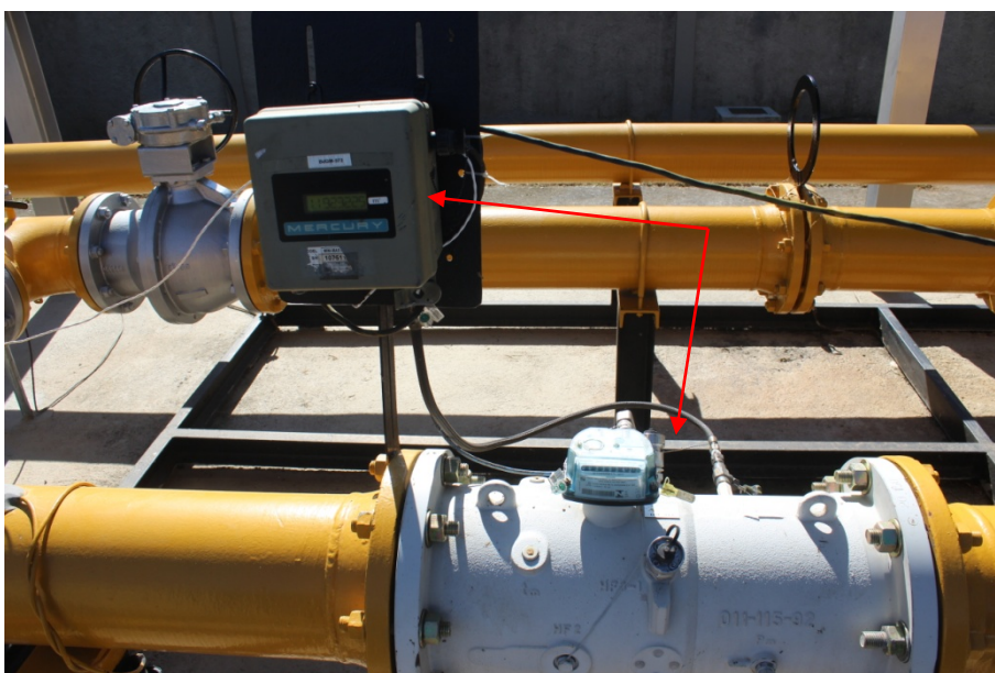
Foto 6: Medidor de vazão Turbina e Conversor de Volume.
