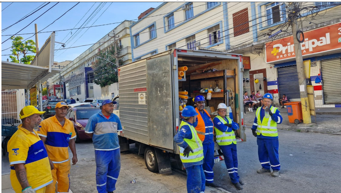
Foto 6: Equipe de reparos e carreta com equipamentos. Hospital ao fundo. Funcionários da Prefeitura ao lado esquerdo. Vazamento já estava contido.
