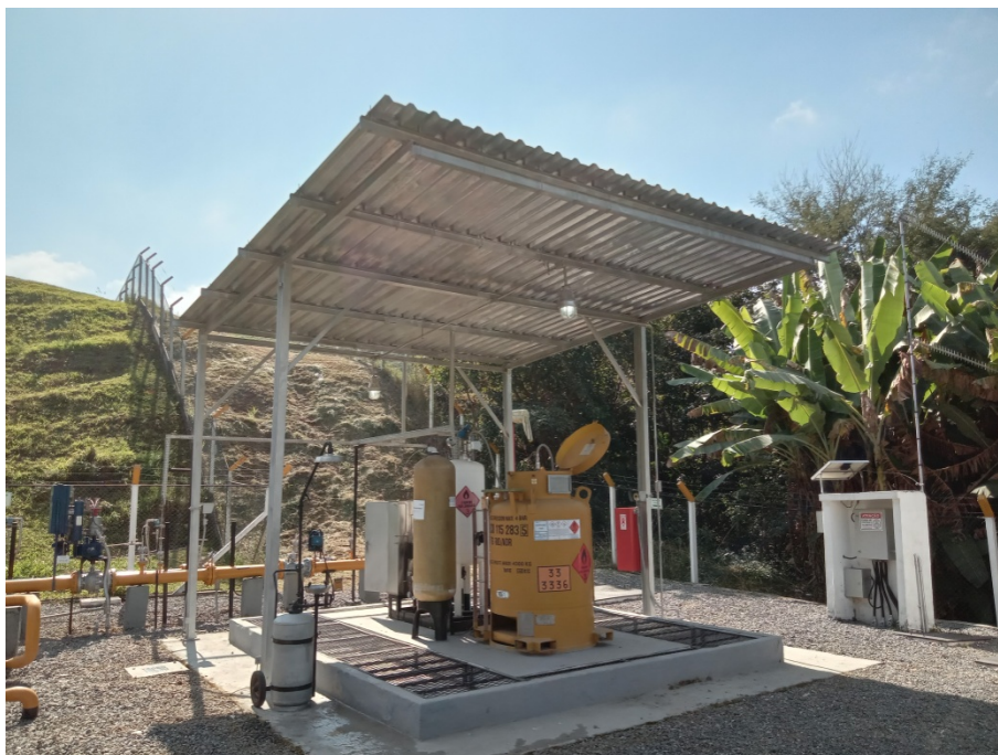
Foto 7: Estação de odorização.
