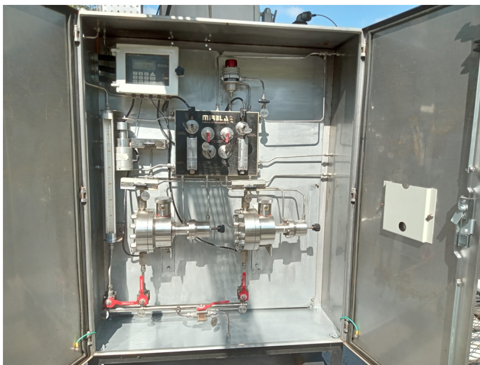
Foto 8: Equipamento de odorização.
