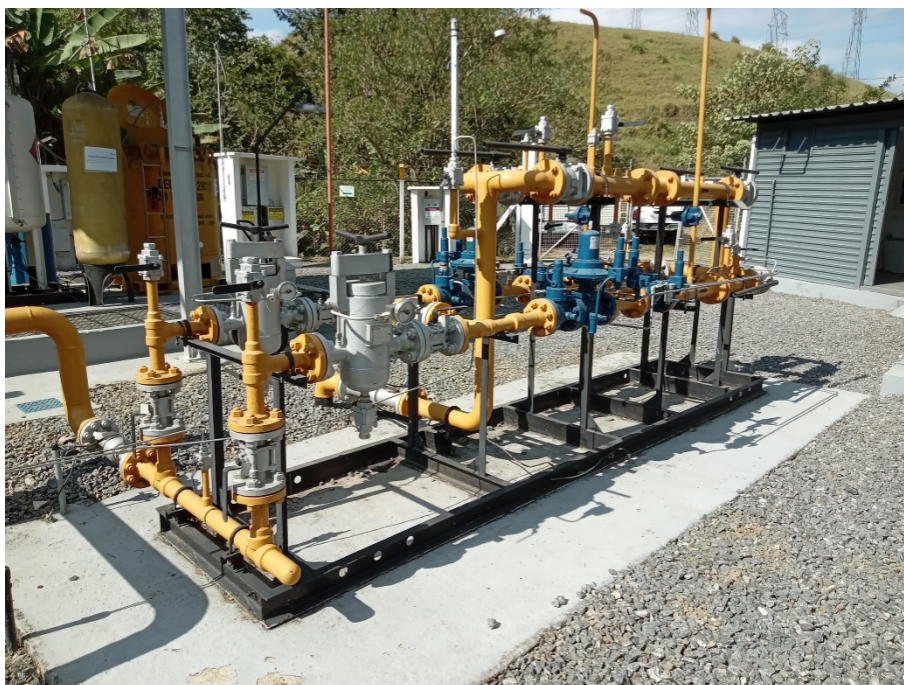
Foto 6: Válvula, filtro, medidor de vazão e reguladores de pressão (ERD).
