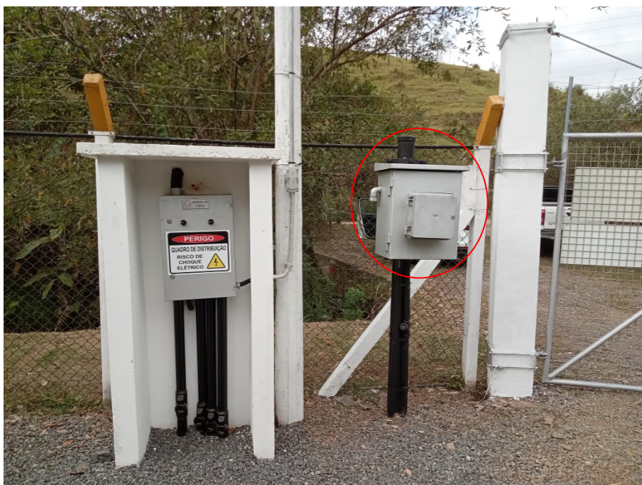
Foto 12: Painel sem sinalização de segurança.
