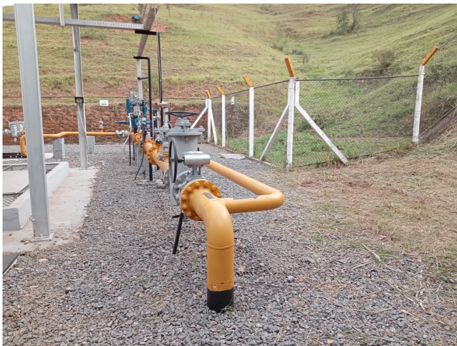
Foto 3: Tubulação de entrada de gás natural (35 bar).
