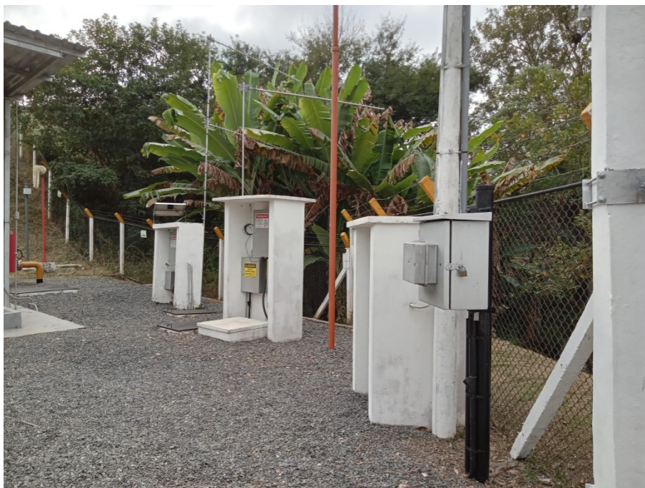
Foto 11: Sistemas elétrico e telemetria.
