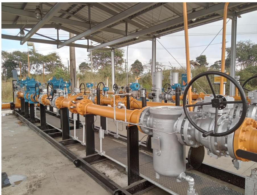
Foto 6: Válvula, filtro, medidor de vazão e reguladores de pressão.
