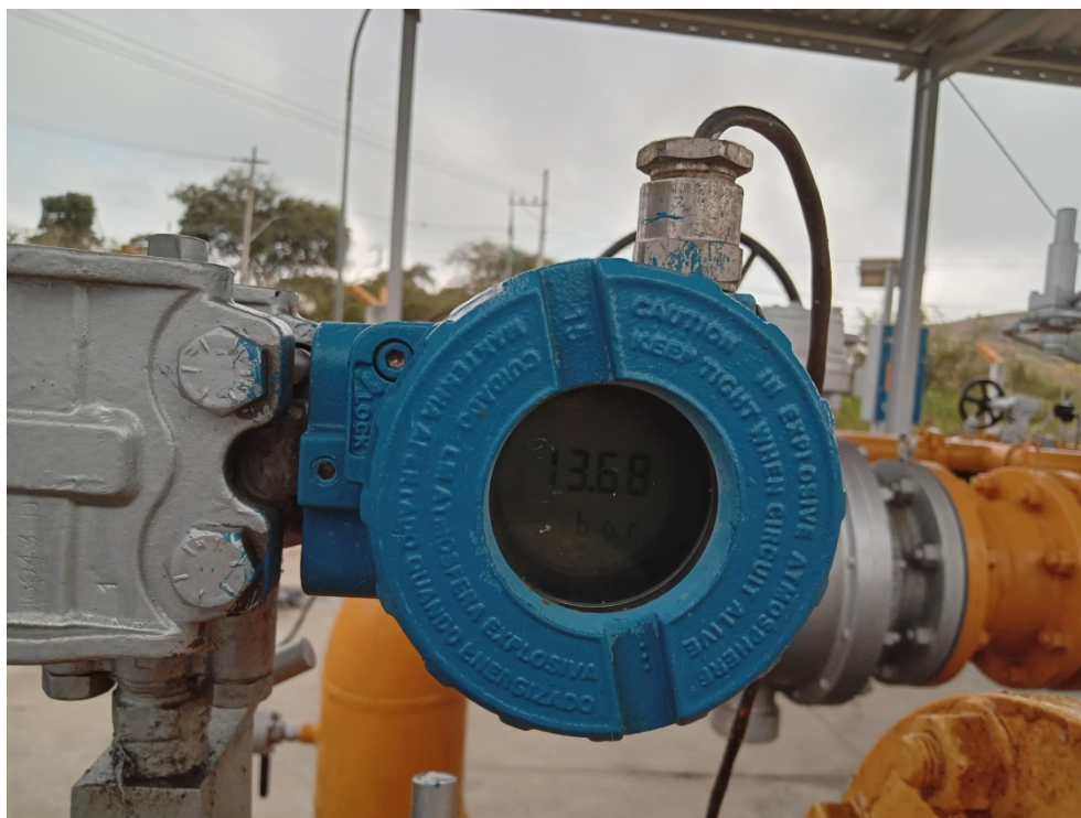
Foto 8: Indicação da pressão na linha de saída da ETC Cidade do Aço.
