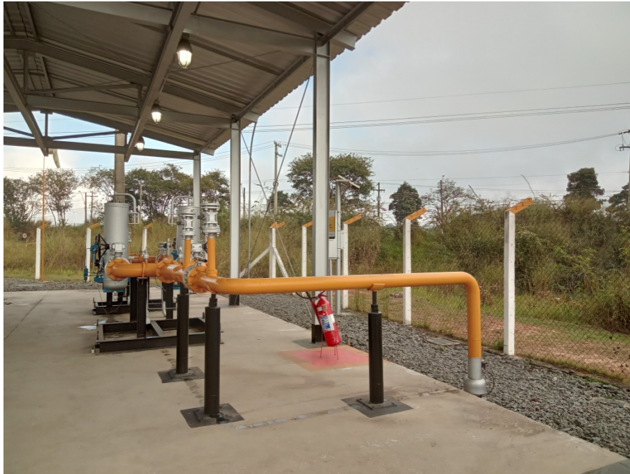
Foto 11: Tubulação de entrada da estação ERD - 14 bar.
