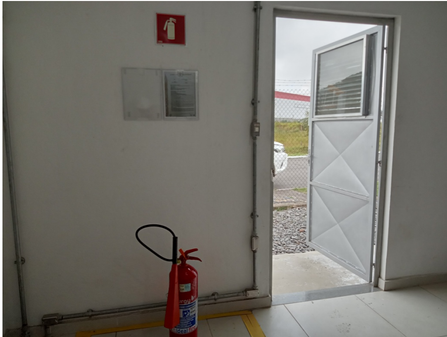
Foto 17: Extintor de CO2 presente na sala de comando.
