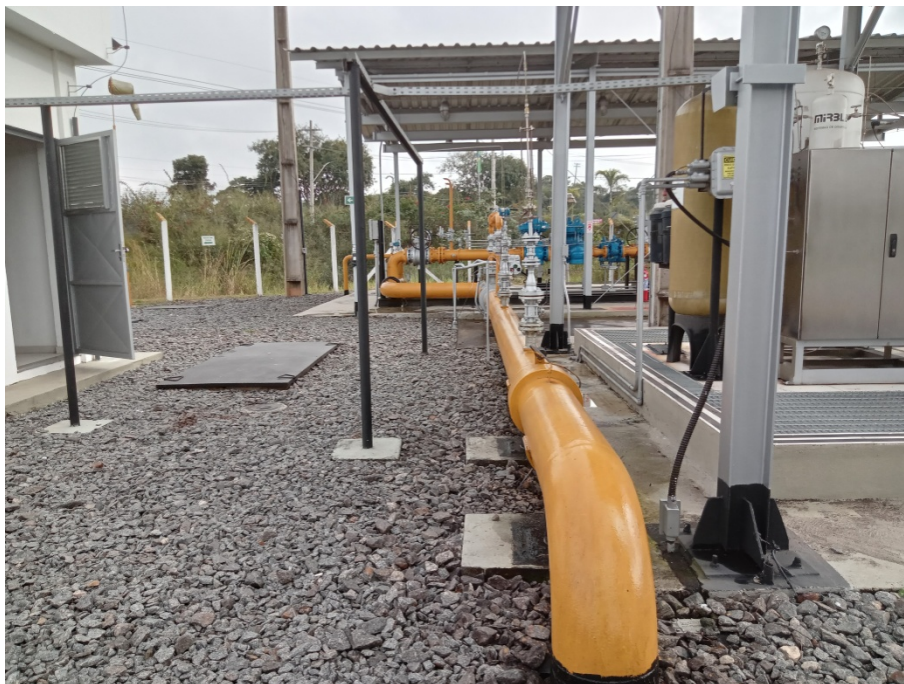
Foto 10: Tubulação de saída da ETC que segue para distribuição e derivação subterrânea para a estação ao lado.
