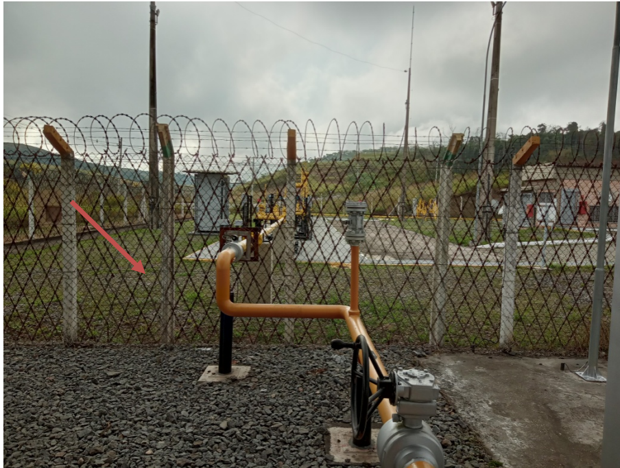
Foto 3: Ponto de entrega NTS em área contígua à ETC Cidade do Aço.
