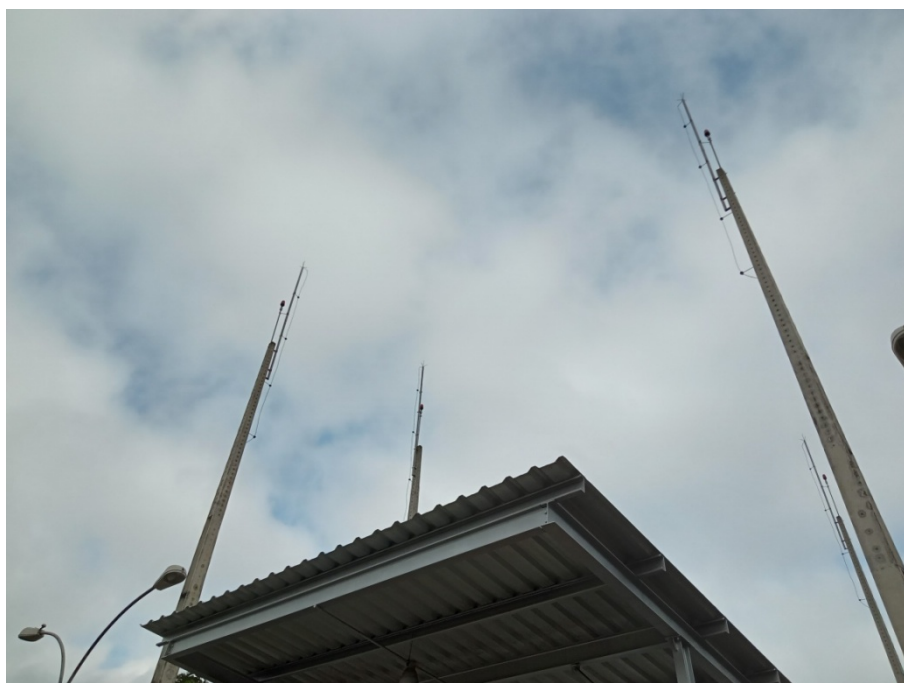
Foto 14: Sistema de proteção contra descargas atmosféricas.
