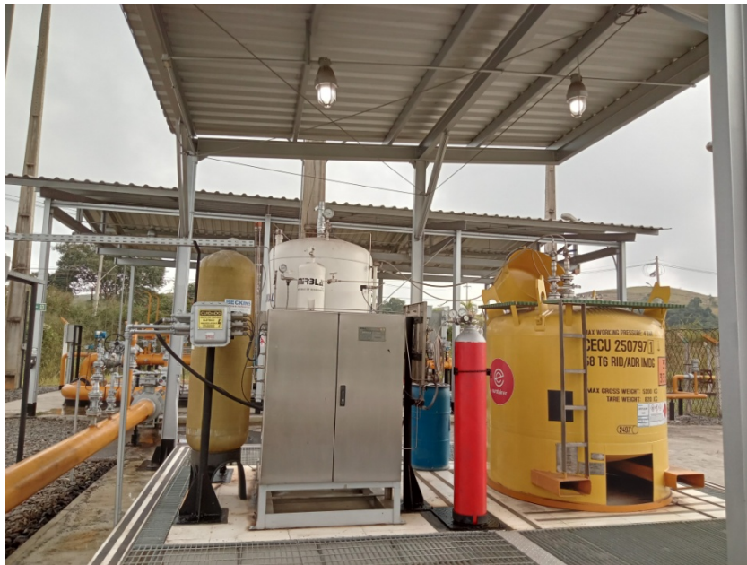
Foto 9: Equipamento de odorização.
