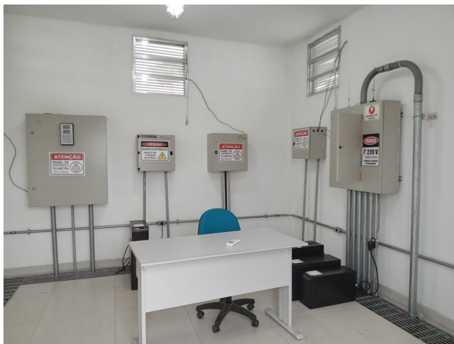
Foto 13: Painéis de comando, telemetria e nobreak.
