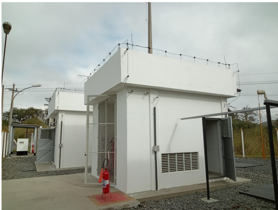
Foto 11: Sala de cromatografia, sala de comando e gerador de emergência ao fundo.
