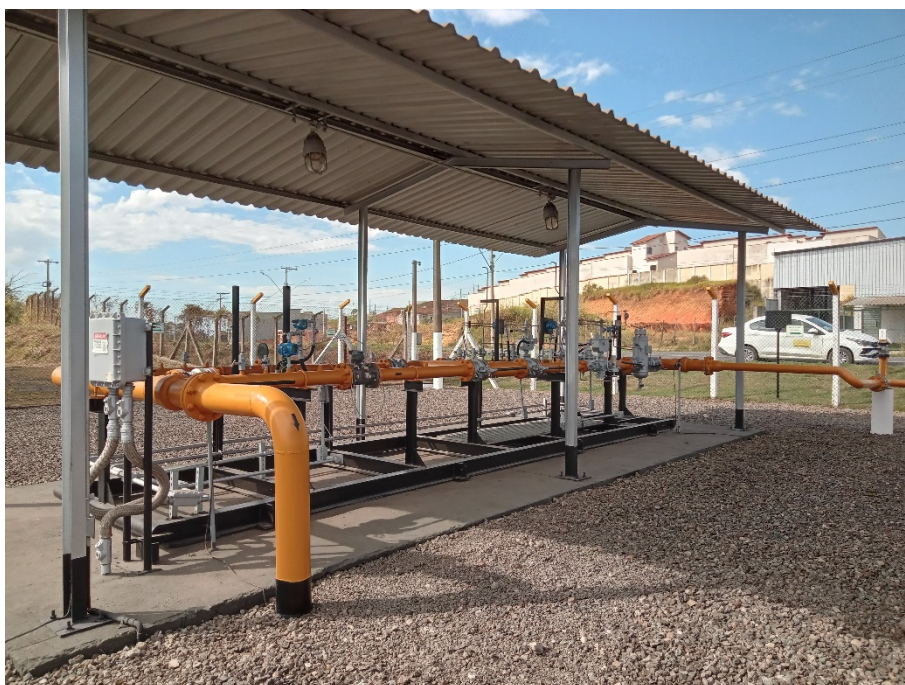
Foto 5: Tubulação de saída da ERM Itatiaia (7 bar).
