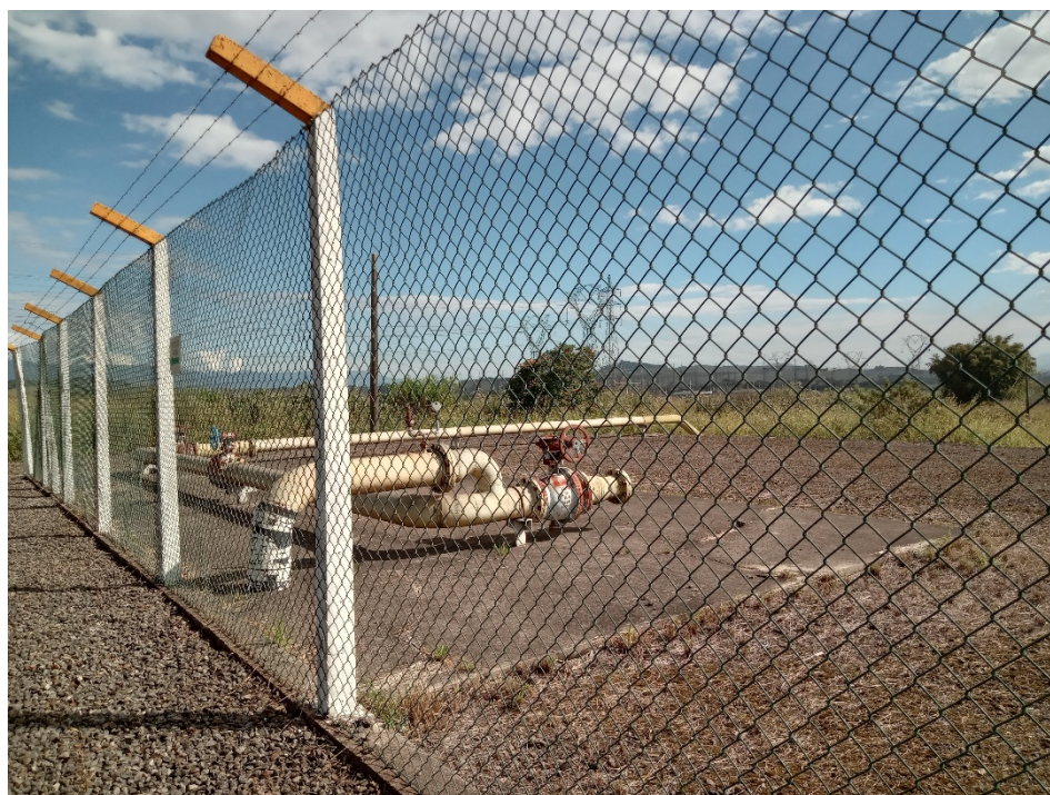
Foto13: Tubulação de gás do cliente
