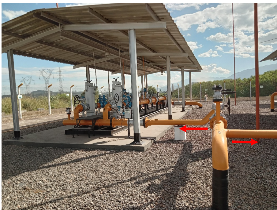
Foto 7: Tubulação de entrada com derivação para as estações.
