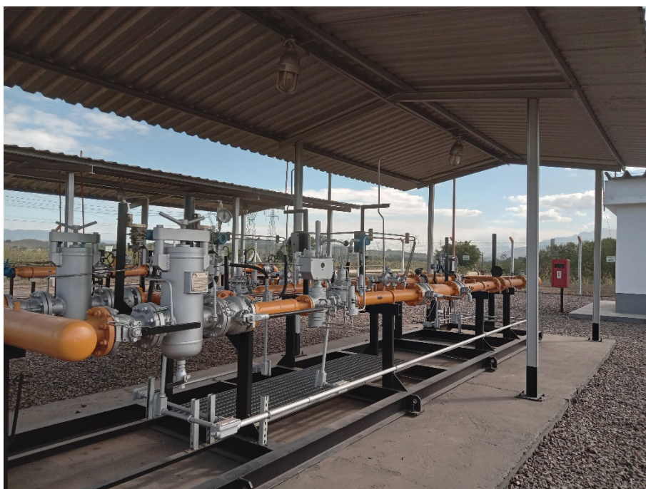
Foto 4: Válvula, filtro, regulador de pressão e medidor (ERM Itatiaia).
