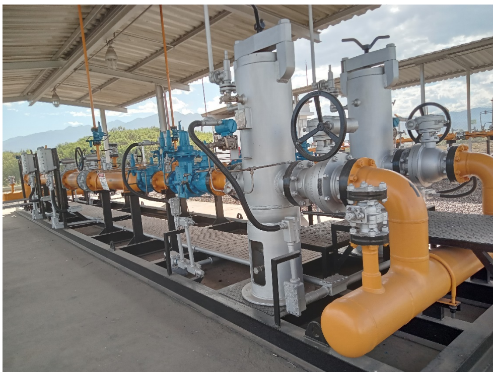
Foto 8: Válvula, filtro, reguladores e medidor de vazão (ERM Votorantim).
