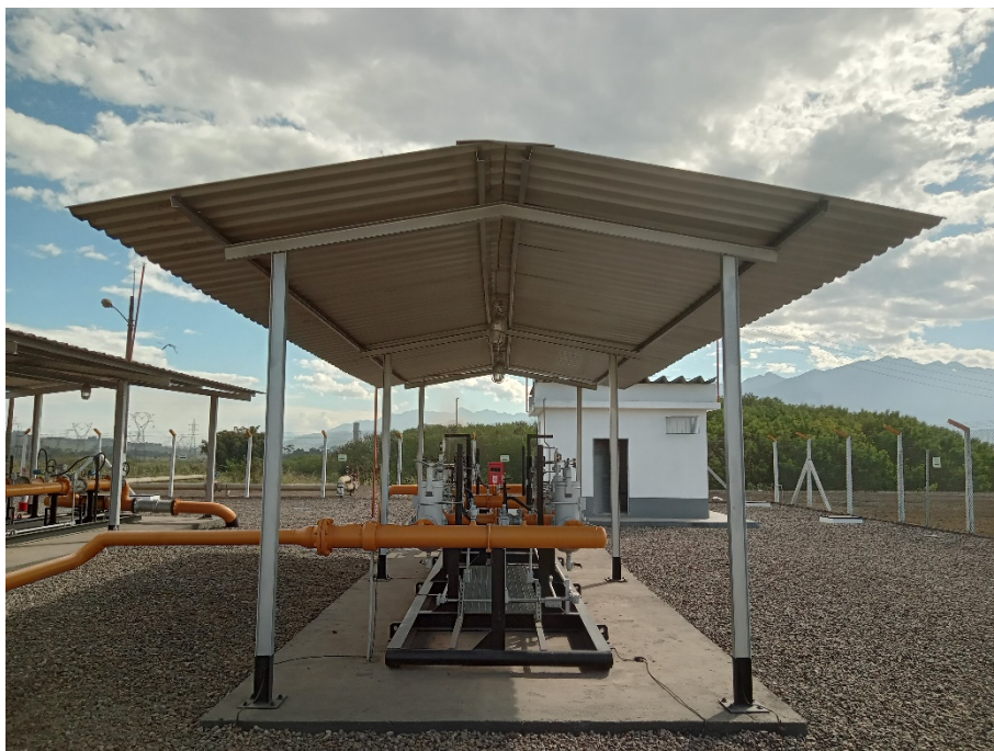
Foto 3: Tubulação de entrada da ERM Itatiaia (16 bar).
