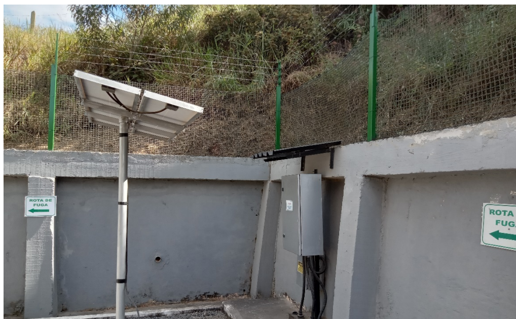
Foto 9: Sistema de energia fotovoltaico.
