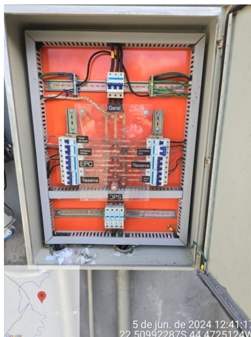
Foto 12: Identificação dos circuitos elétricos do quadro de distribuição.
