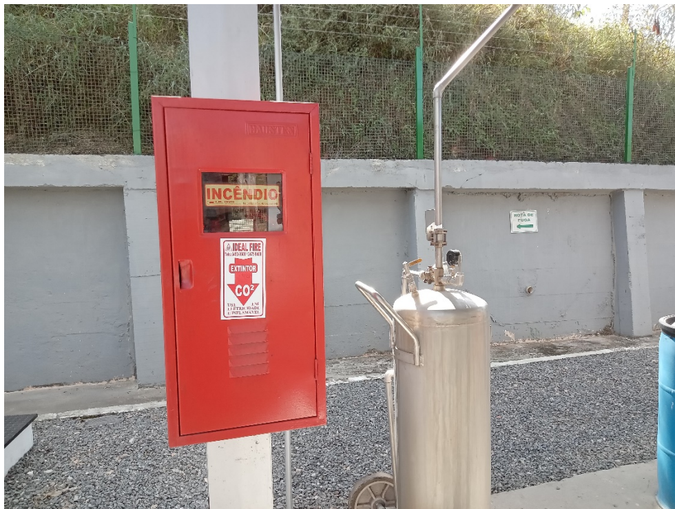
Foto 8: Extintor de incêndio, lava-olhos e chuveiro de emergência.
