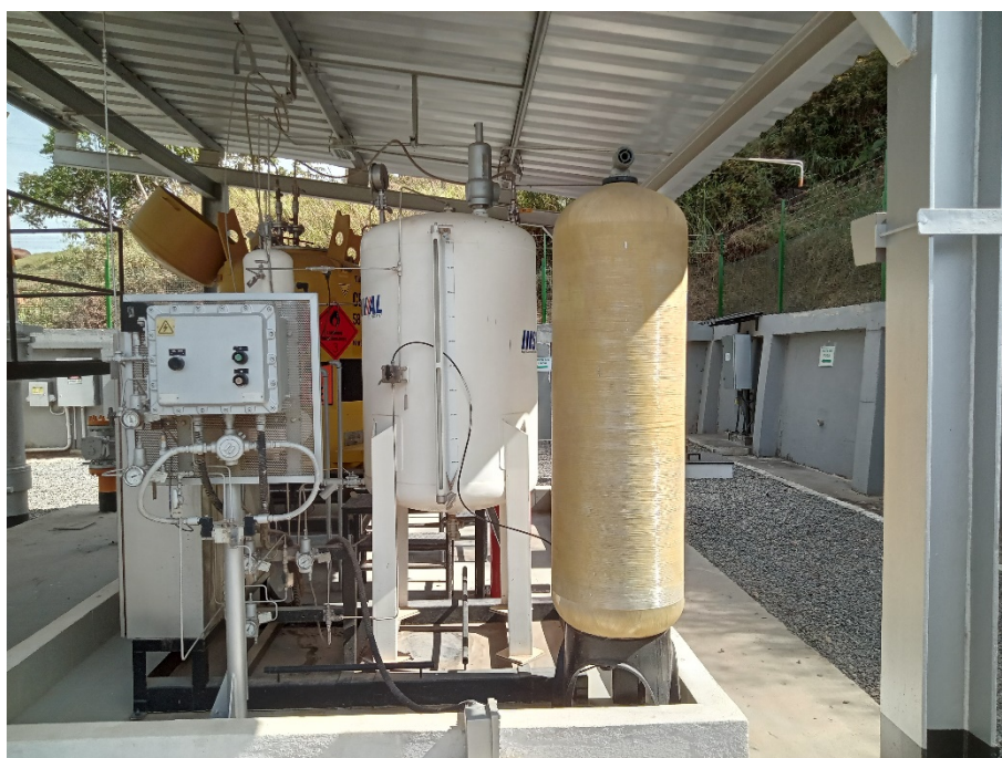
Foto 6: Sistema de odorização.
