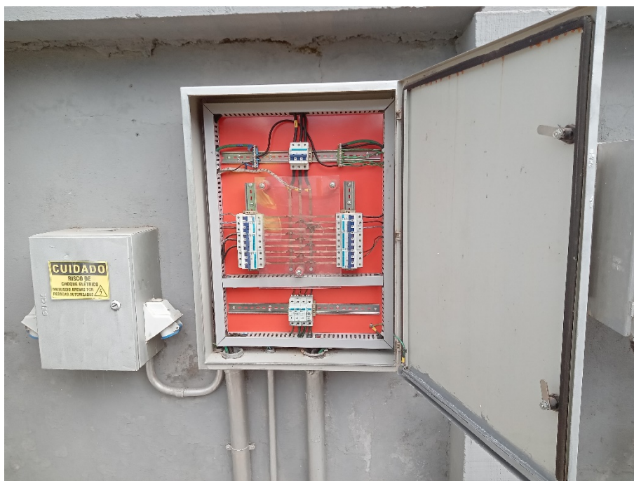
Foto 11: Quadro de distribuição sem identificação dos circuitos.
