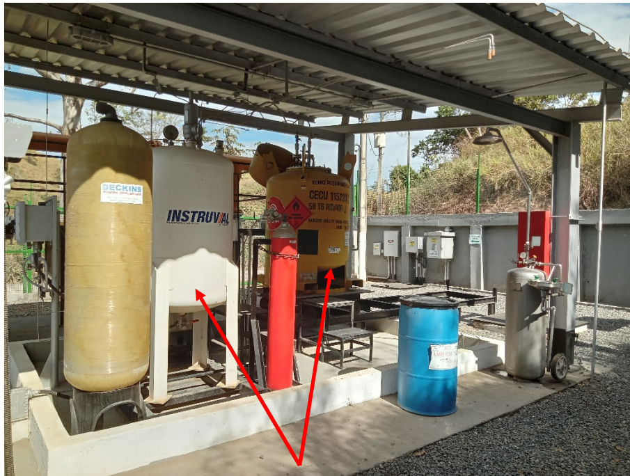
Foto 7: Tanques de armazenamento de odorante (Primário e secundário).
