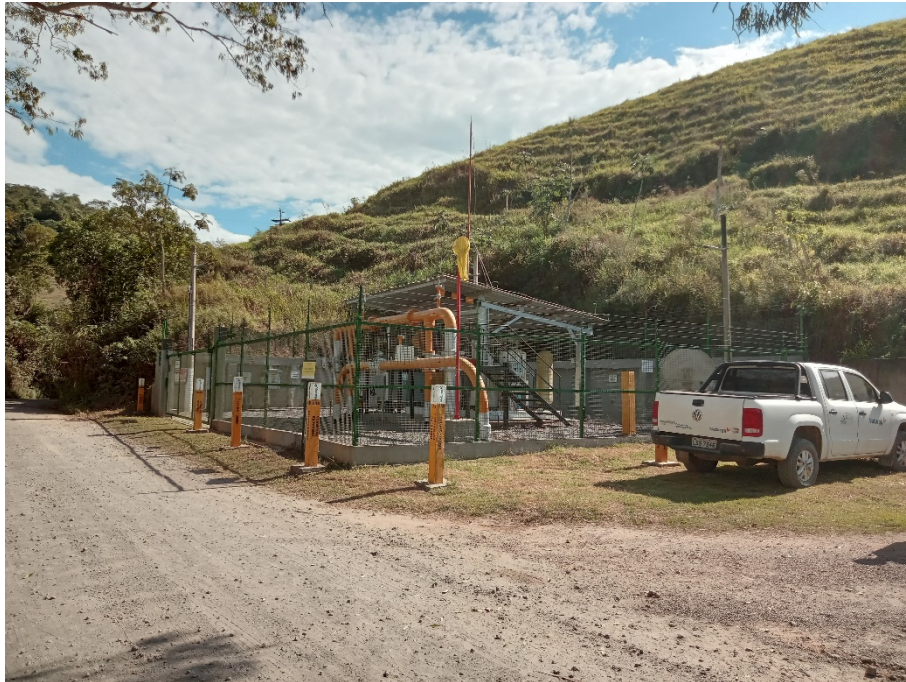
Foto 3: Vista geral da estação de odoração.
