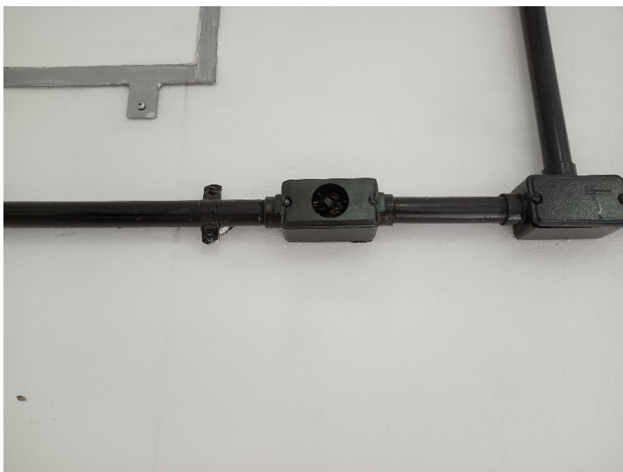
Foto 11: Ponto de instalação sem proteção.
