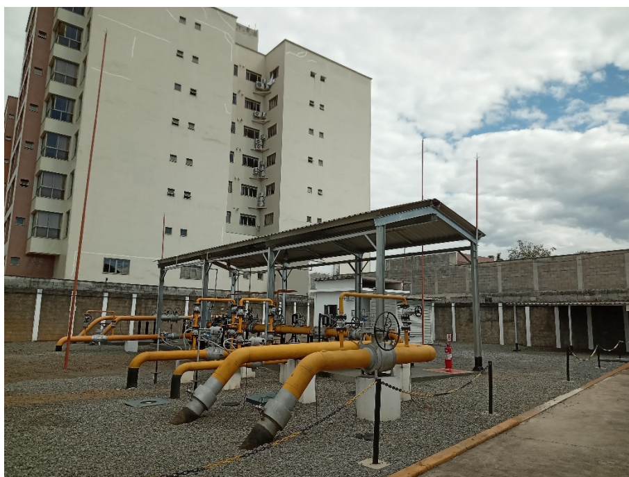
Foto 6: Linhas de saída para distribuição.
