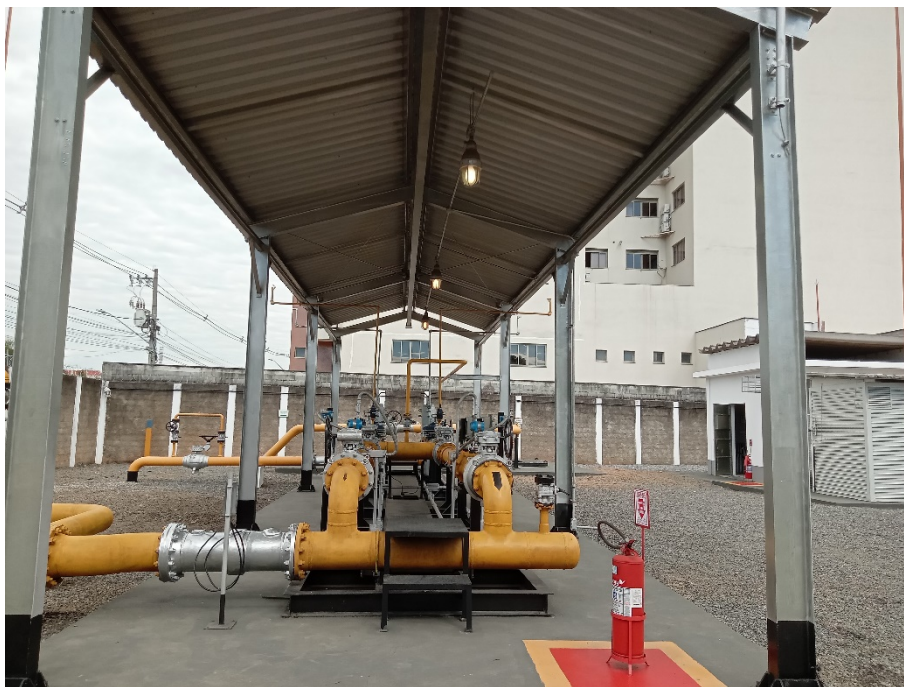
Foto 5: Tubulação de saída da estação.
