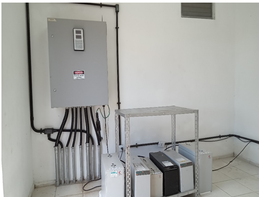
Foto 9: Painel de telemetria e nobreak.
