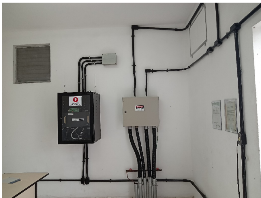
Foto 10: Painel elétrico e telemetria.
