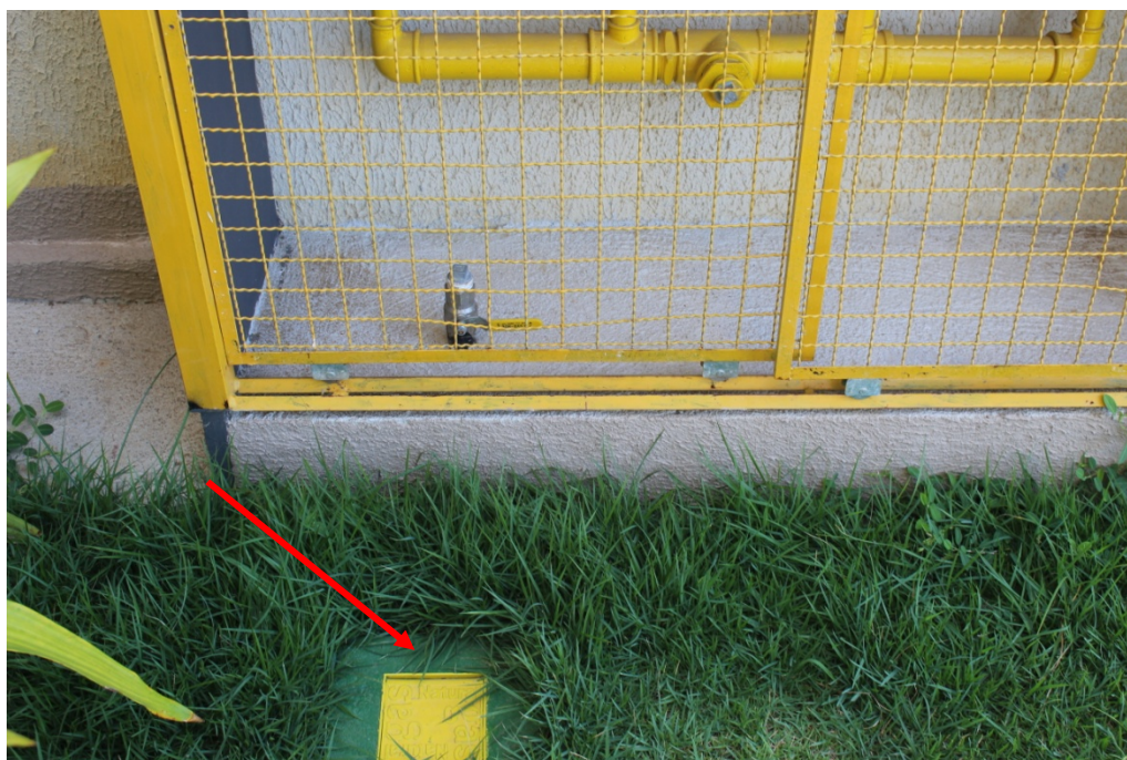
Foto 5: Válvula de bloqueio do ramal do PI
