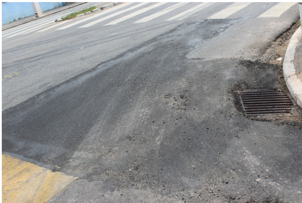
Foto 3: Reparo mal feito.
