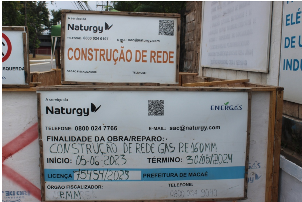
Foto 1: Placa de identificação da obra insuficiente.
