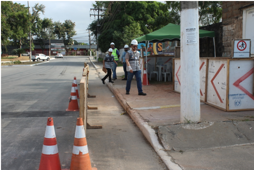
Foto 7: Tapume sem sinalização noturna (Fiscalização AGENERSA).
