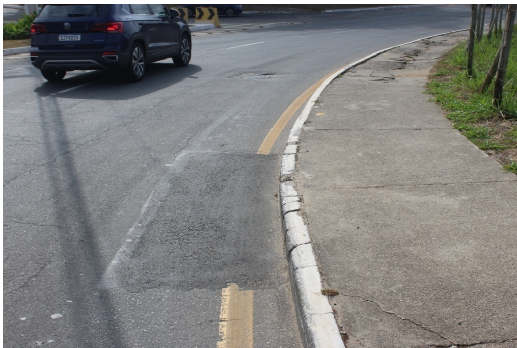
Foto 4: Recomposição sem a devida pintura da faixa da via.
