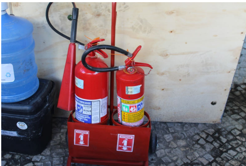
Foto 10: Extintores presentes no local de vivência.
