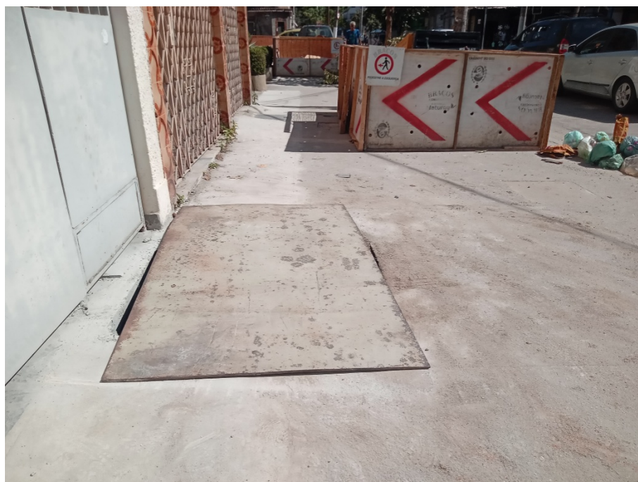
Foto 8: Chapa de aço oferecendo risco de tropeço aos transeuntes (lado par).
