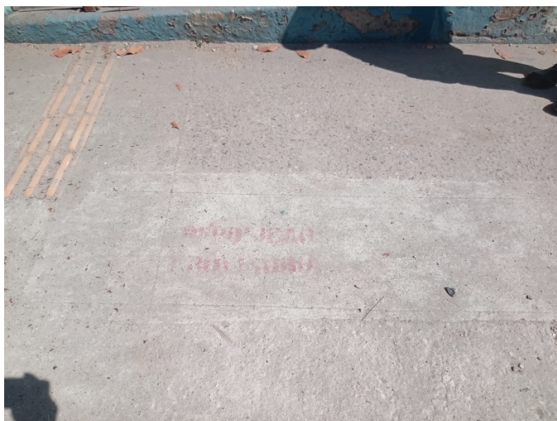
Foto 5: Recomposição provisória com tinta inelegível.
