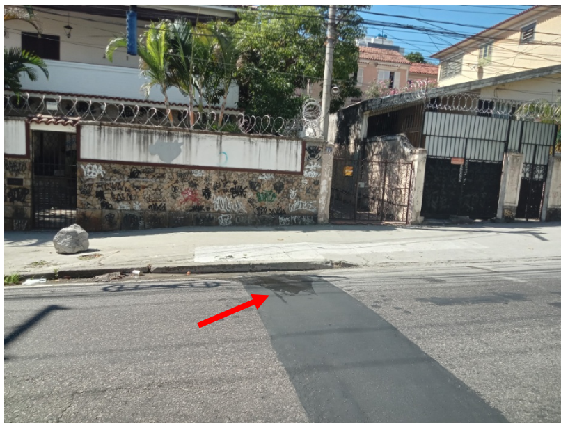
Foto 9: Indício de vazamento de água em área de recomposição de travessia de ramal.
