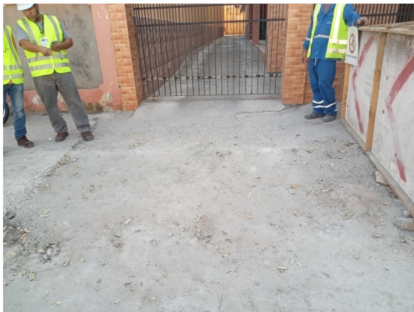
Foto 5: Recomposição insuficiente no passeio.
