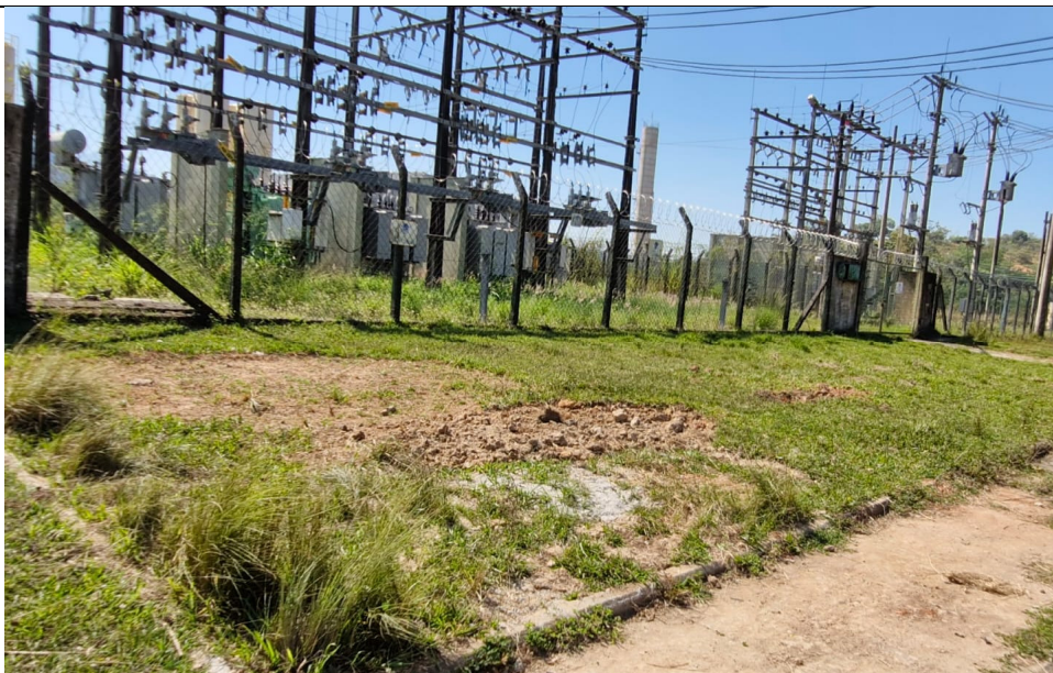
Foto 13: Trecho com recomposição provisória inadequada e não sinalizado.
