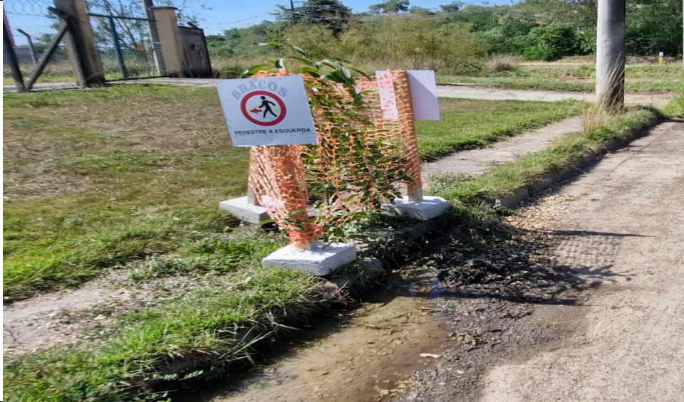
Foto 5: Sinalização de boca de lobo destampada e vazamento.
