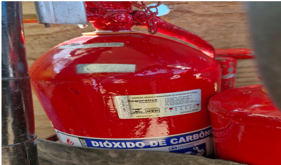
Foto 3: Extintor na área de vivência, recém inspecionado.
