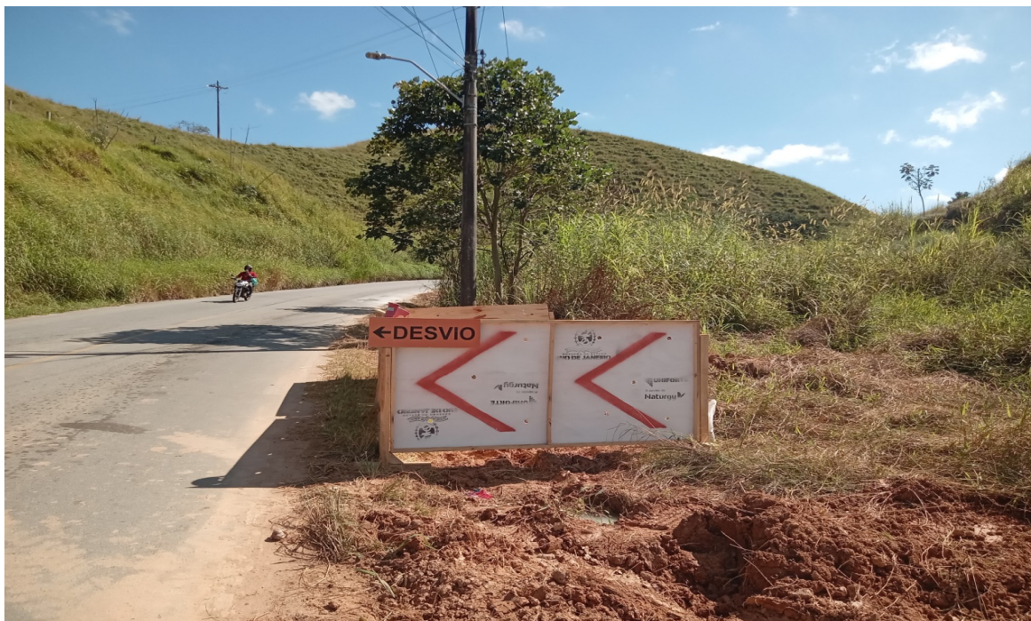
Foto 8: Isolamento de obra com sinalização noturna mal posicionada.
