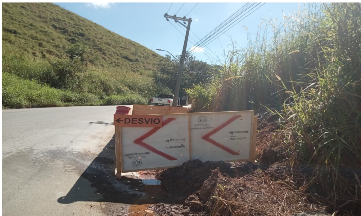
Foto 10: Ponto onde a rede se encontra parada
