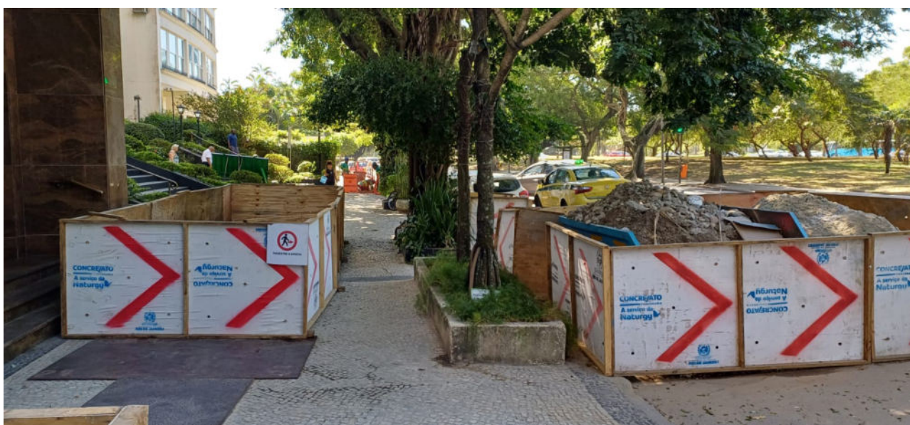
FOTO 08 – Vista de outra restrição no local.
