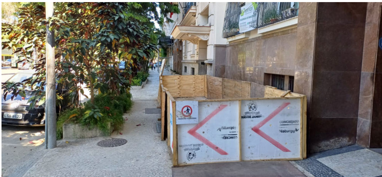
FOTO 07 – Vista da restrição imposta à passagem de pedestres, por força da necessária interdição por tapumes, porém por tempo desnecessário e sem atuação de equipes no local.
