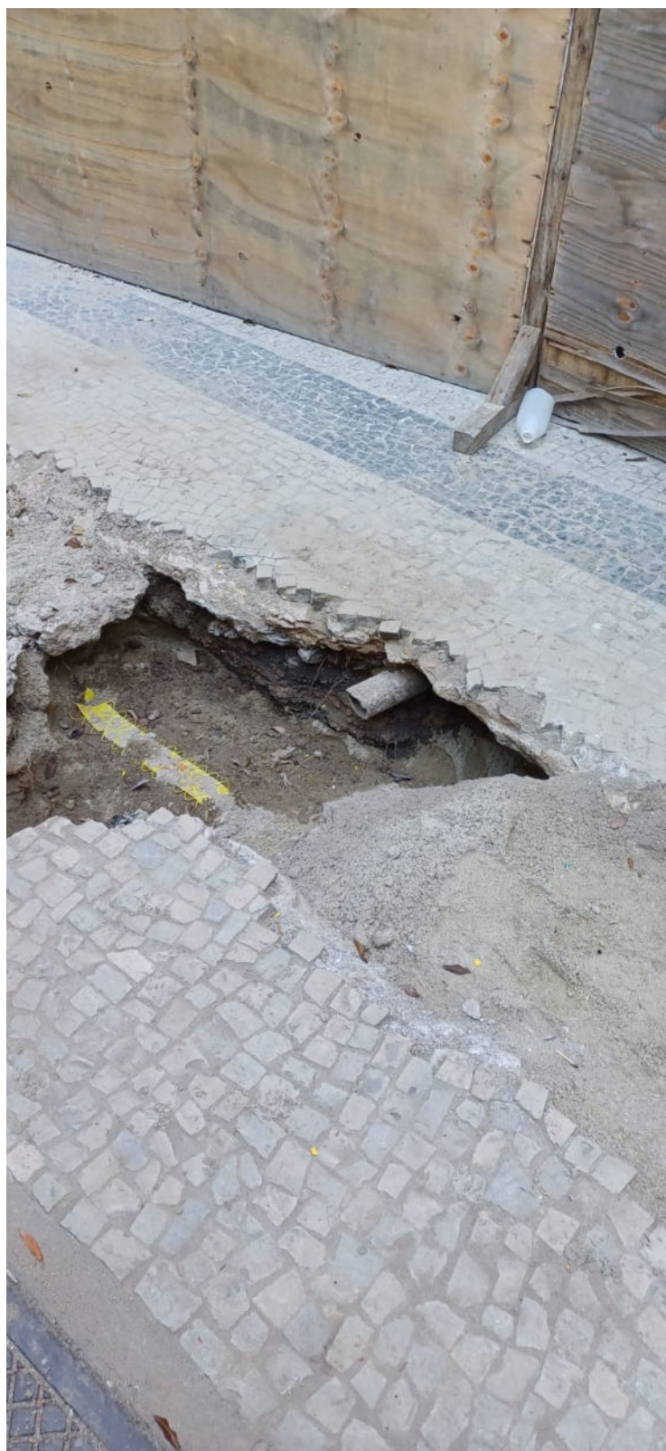
FOTO 06 – Detalhe do tubo extravasor do número 300, ainda sem reparo do rompimento produzido pela abertura da vala.
