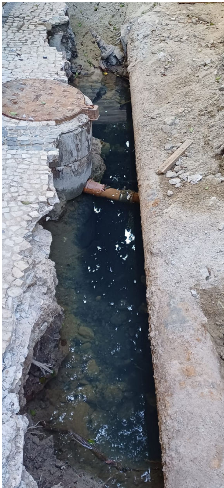
FOTO 03 – Vista da vala inundada. Observa-se um acoplamento de PVC na caixa de esgoto do prédio. Este acoplamento foi executado pela CONCREJATO, uma vez que a tubulação original fora rompida. Há vazamento neste acoplamento.
