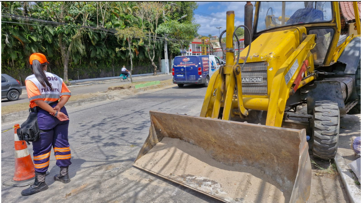
Foto 2: Retroescavadeira que causou o incidente. Ao lado, desvios e operador de trânsito.
