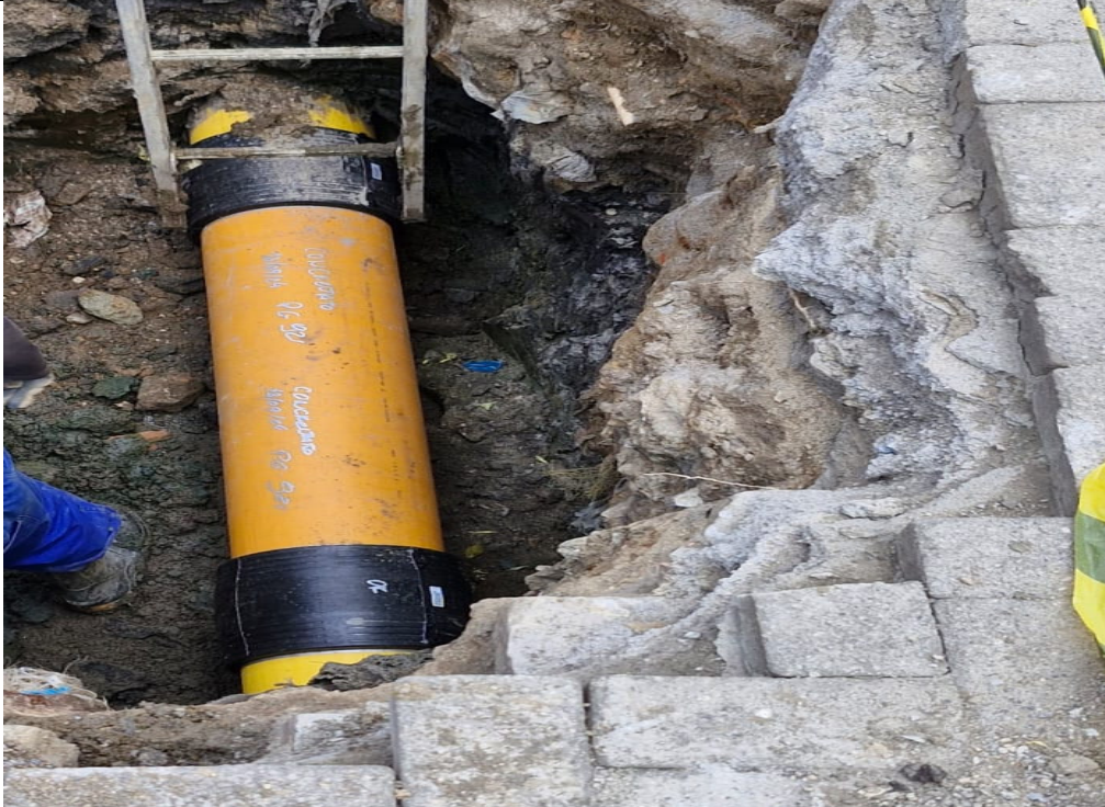
Foto 1: Trecho de rede que sofreu avaria, já reparado pela equipe responsável da Concessionária.
