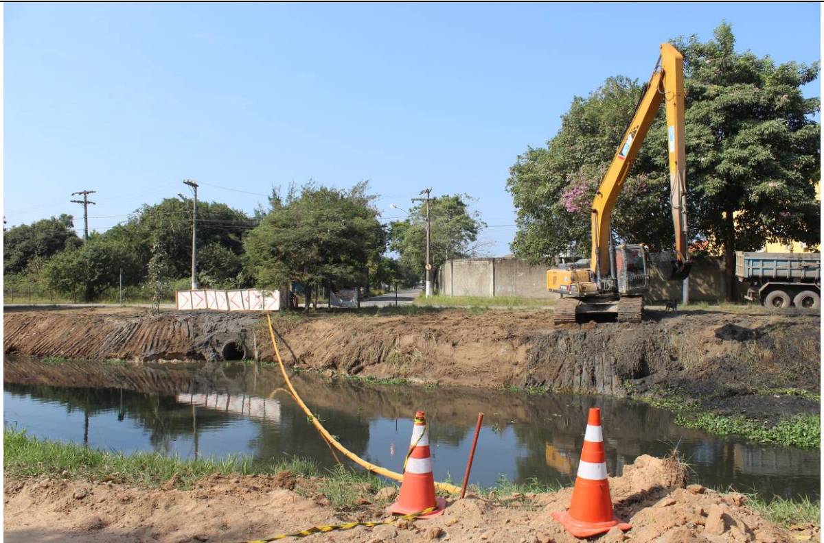
Foto 6: Canal onde houve o rompimento do duto de gás da Naturgy e o bypass já colocado sobre o canal.
