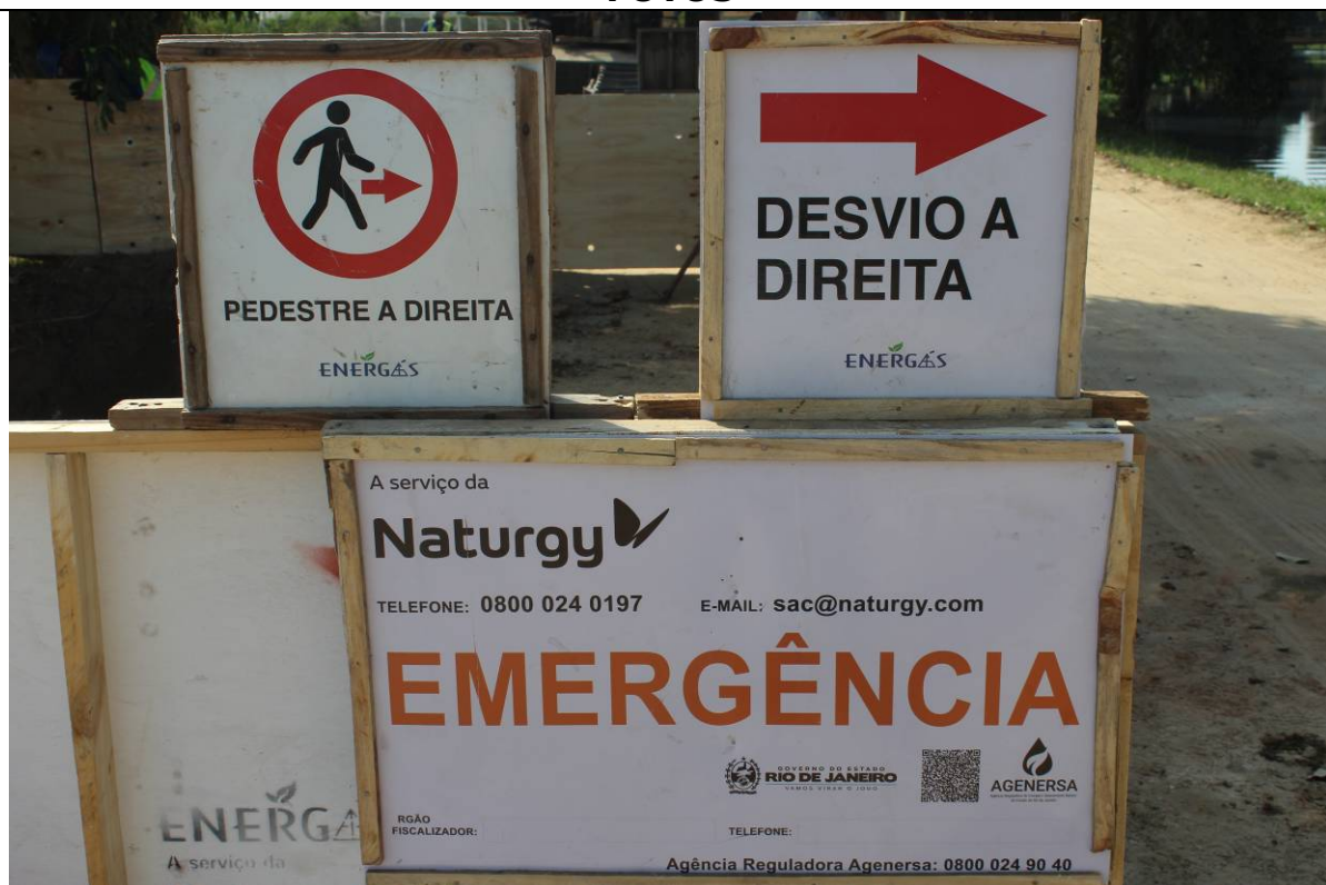
Foto 3: Placas de sinalização de emergência da obra, de desvio de pedestres e de trânsito.
