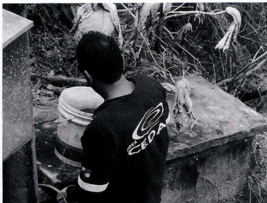
Aplicação de corante na Galeria (fig 06)
