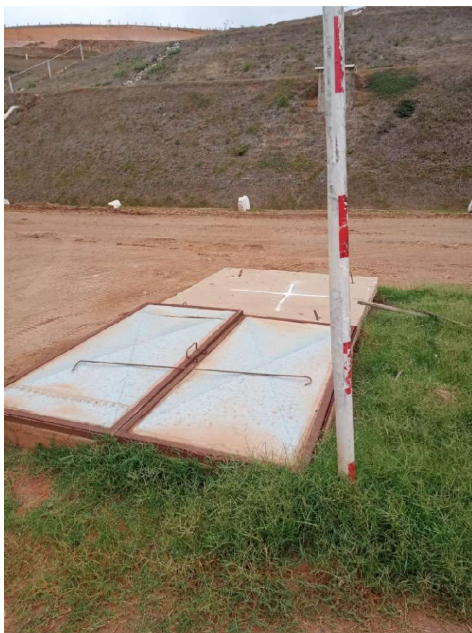
Figura 15: Caixa de passagem do chorume oriundo da célula
