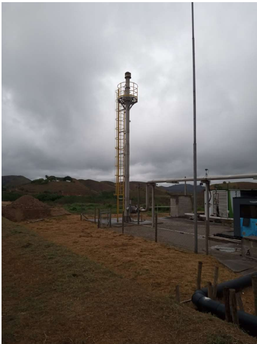
Figura 29: Flare da Estação de Biogás
