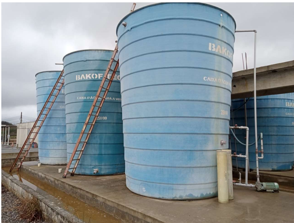
Figura 20: Tanques da estação de tratamento de chorume
