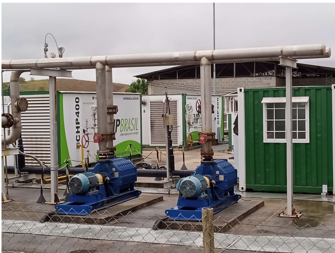
Figura 28: Estação de biogás
