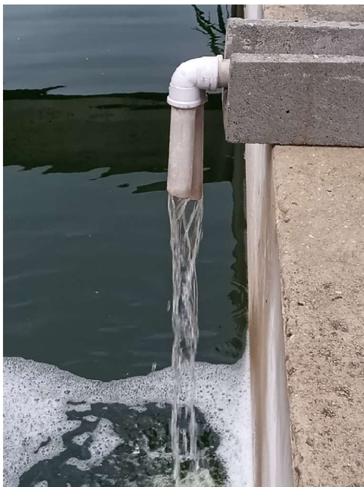
Figura 23 : Tanque de recebimento de água de reuso após tratamento
