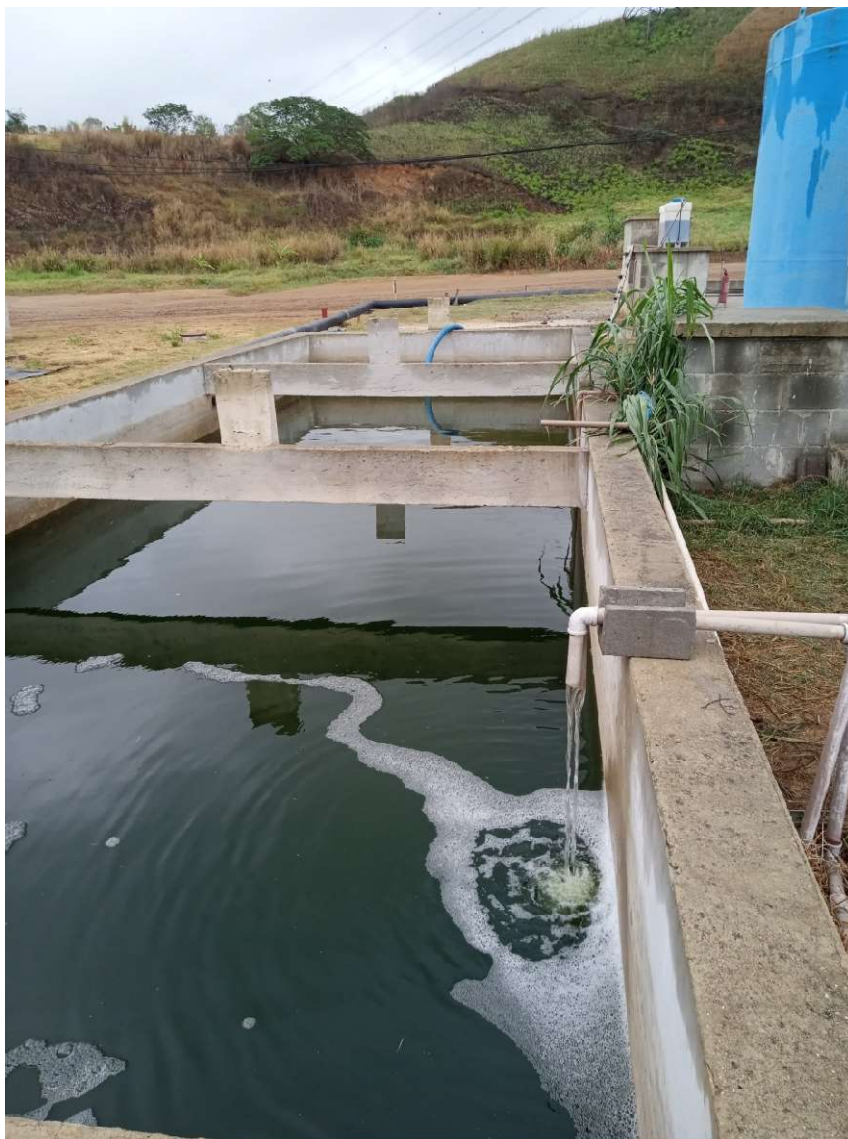
Figura 22 : Tanque de recebimento de água de reuso após tratamento
