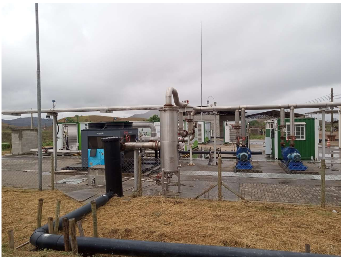
Figura 27: Estação de biogás
