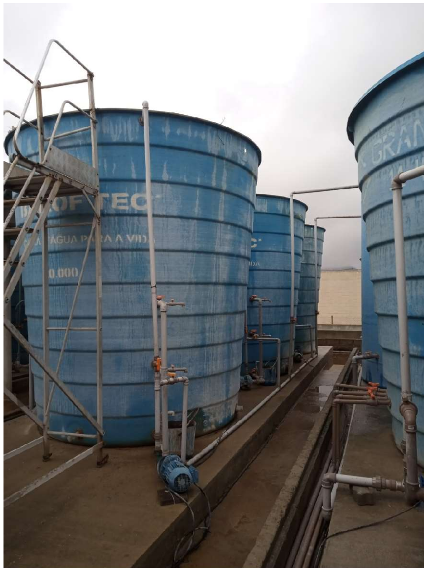
Figura 21 : Tanques da estação de tratamento de chorume
