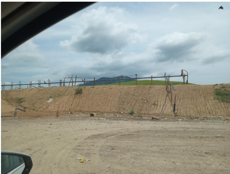
Figura 4: Dutos de captação de gás
