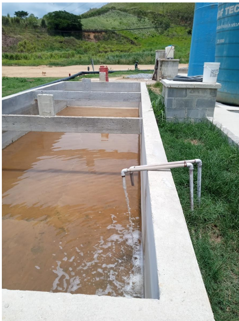
Figura 14 : Reservatório para armazenamento do chorume pós tratamento
