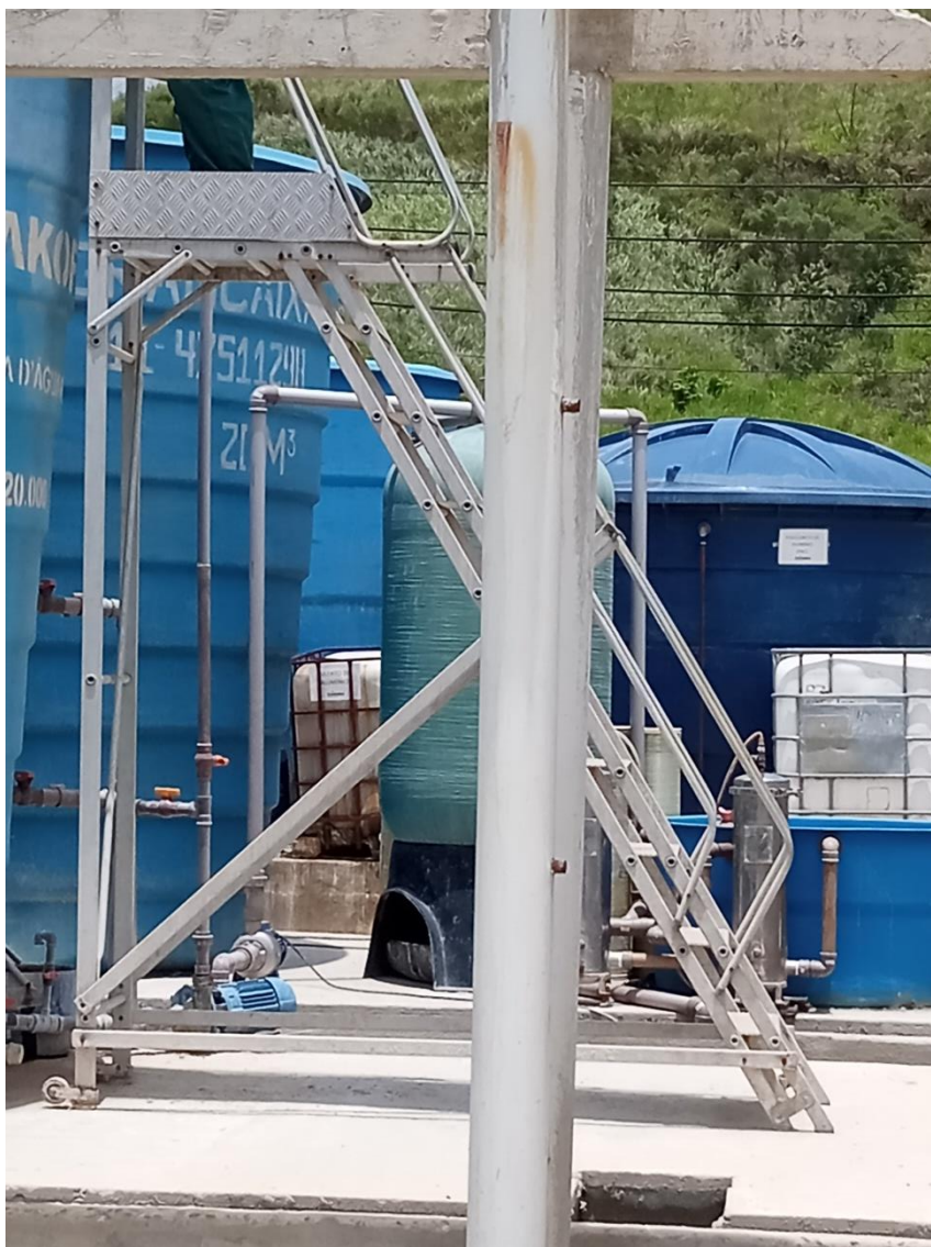
Figura 13 : Tanques da estação de tratamento de chorume
