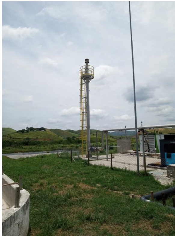
Figura 18: Flare da Estação de Biogás
