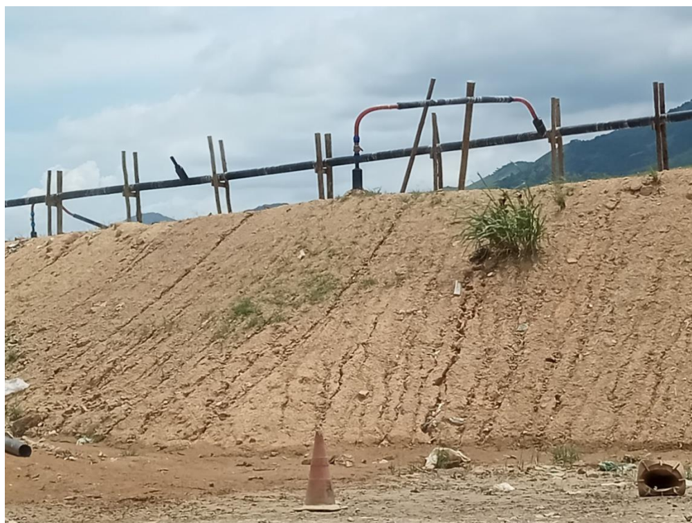
Figura 5: Dutos de captação de gás
