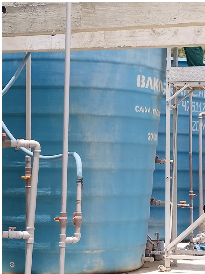
Figura 12: Tanques da estação de tratamento de chorume
