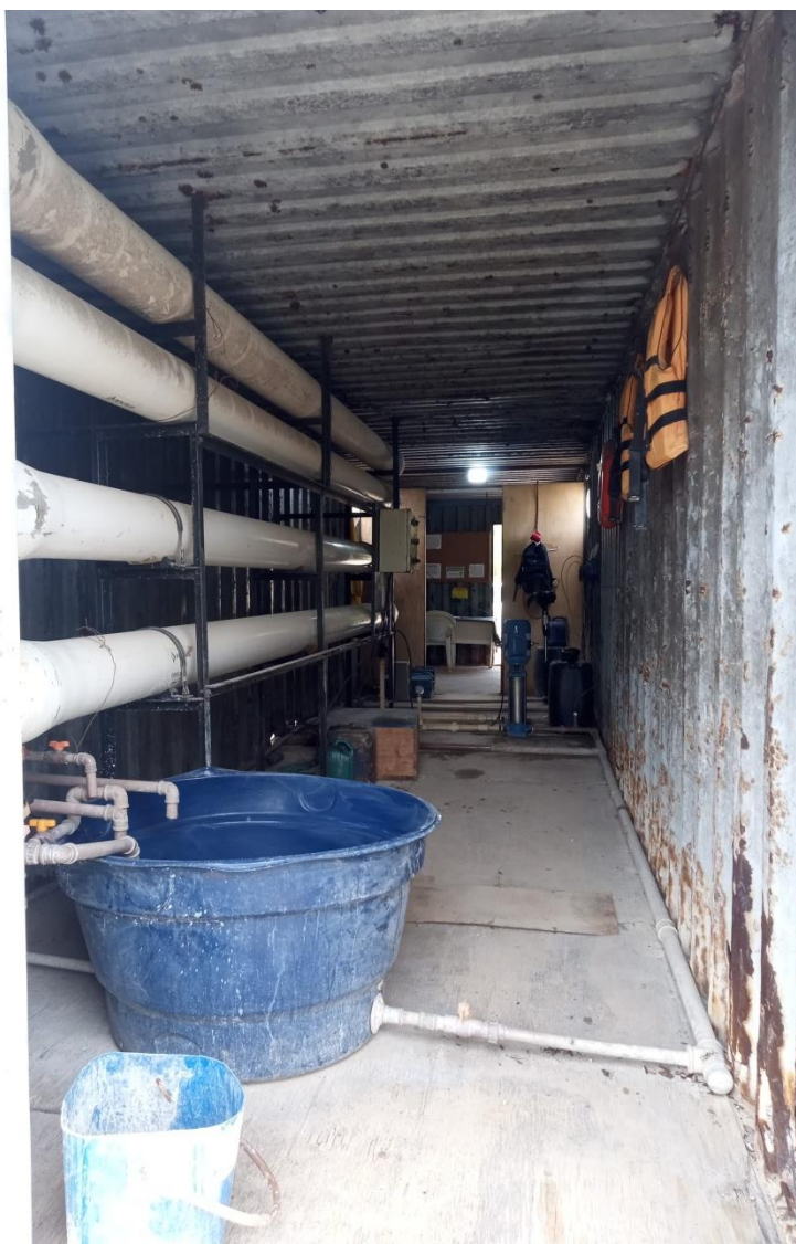
Figura 11: Equipamento de Osmose reversa
