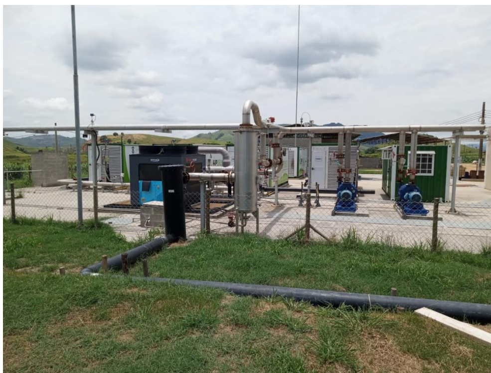
Figura 17: Estação de biogás
