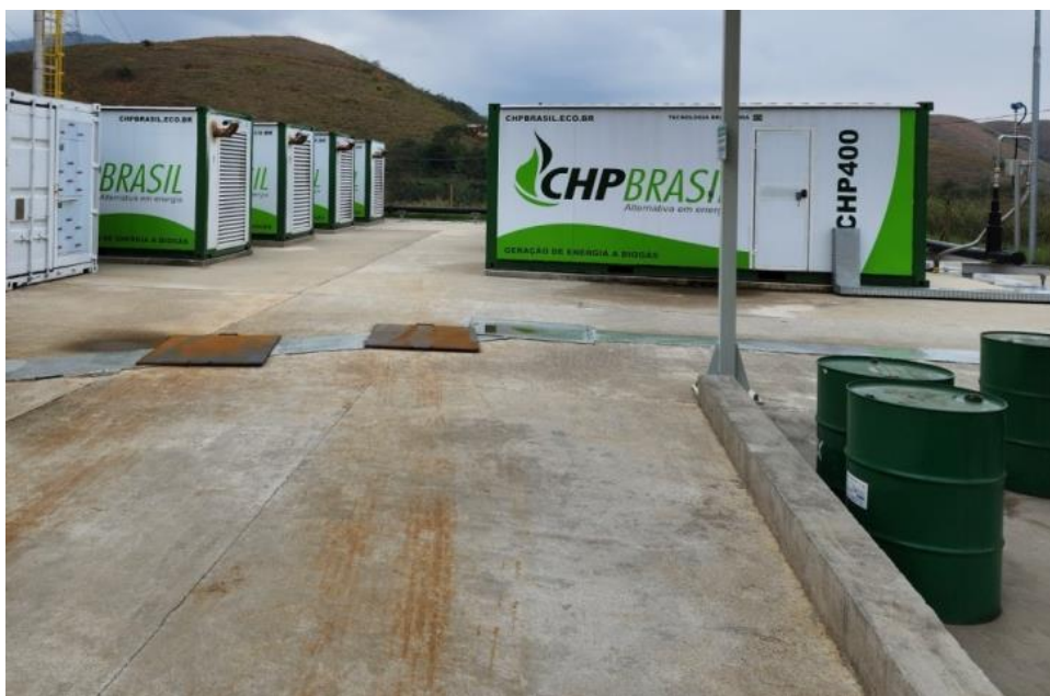
Figura 13: Geradores da estação de biogás
