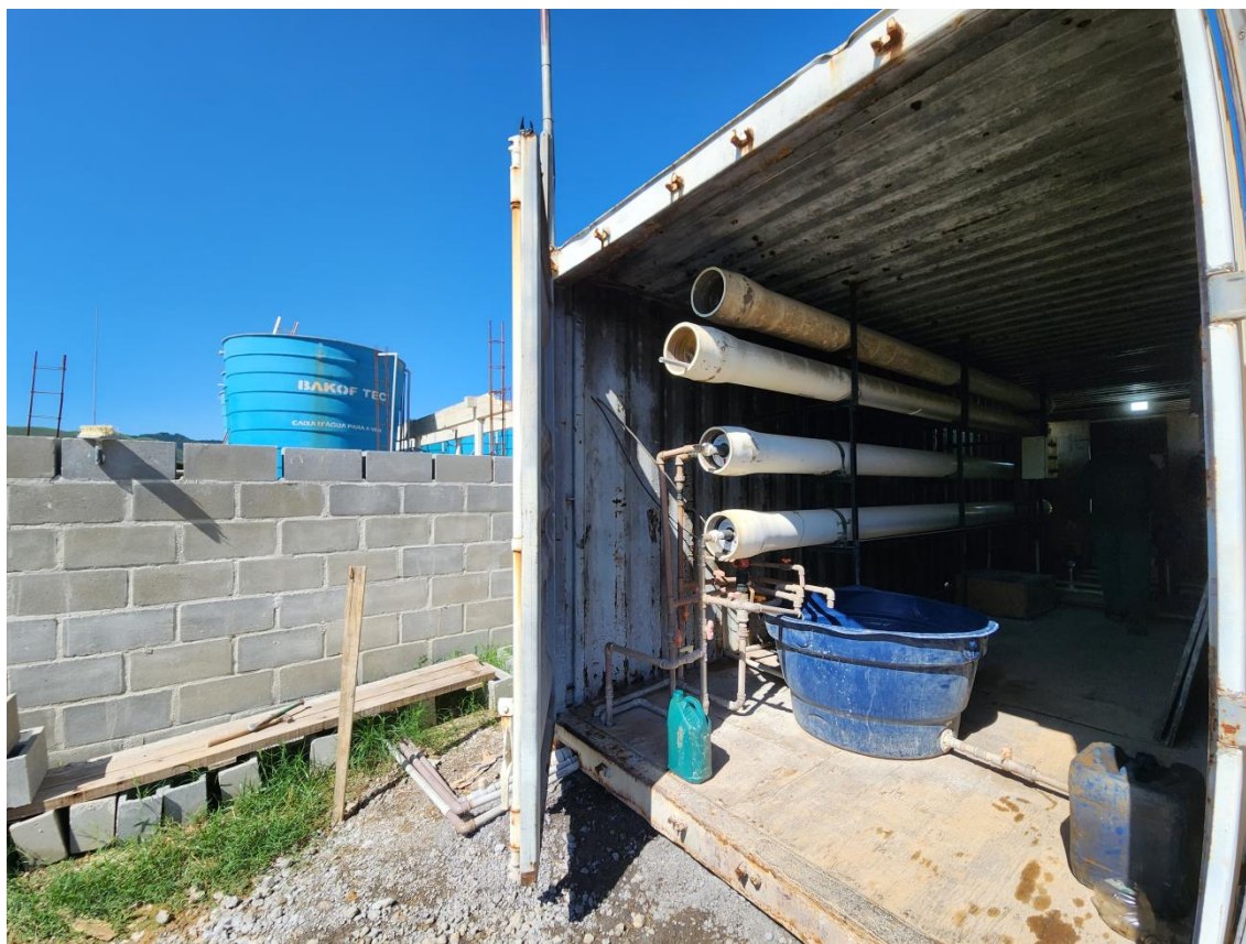
Figura 10 : Equipamento de Osmose reversa para tratamento do chorume
