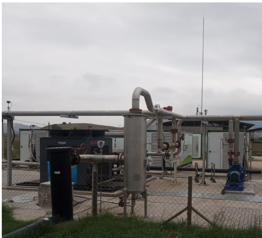
Figura 14: Visão da estação de biogás.
