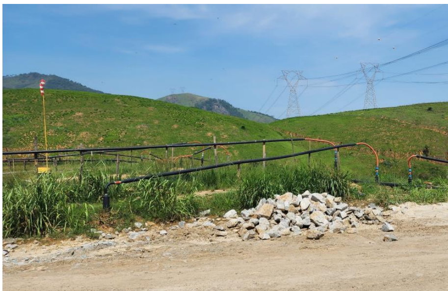
Figura 6: Dutos de captação de gases.
