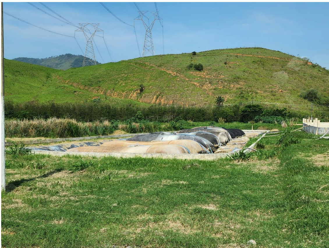
Figura 10: BAGS de armazenagem e secagem de lodo.
