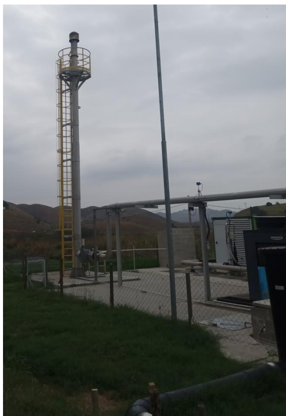
Figura 17: Flare da Estação de Biogás
