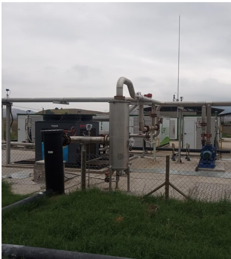
Figura 16: Visão da estação de biogás.
