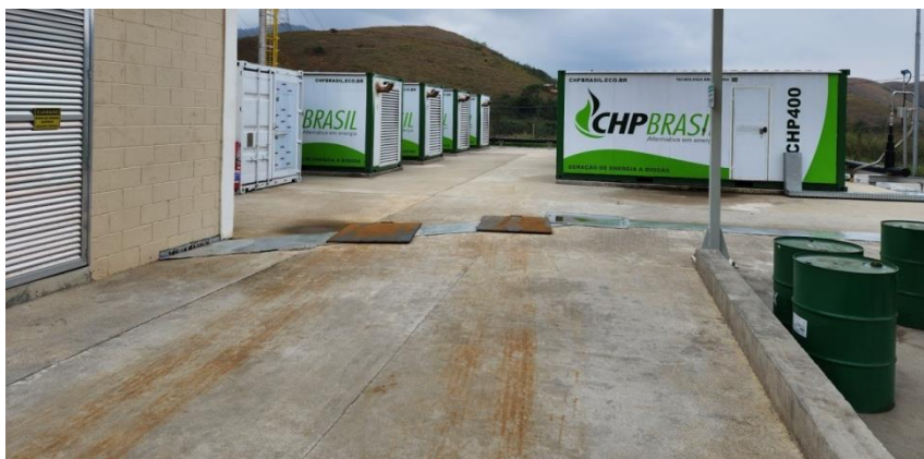
Figura 15: Geradores da estação de biogás
