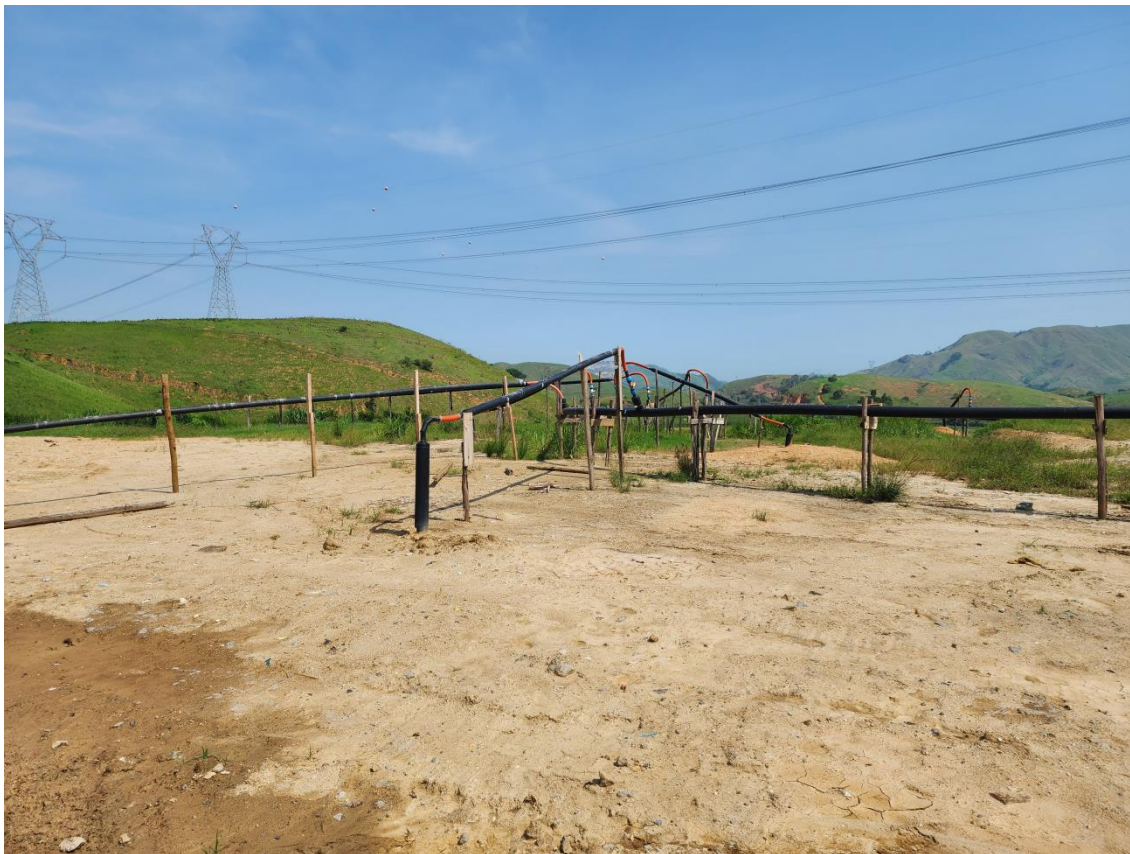
Figura 6: Captação dos gases para a estação de biogás.
