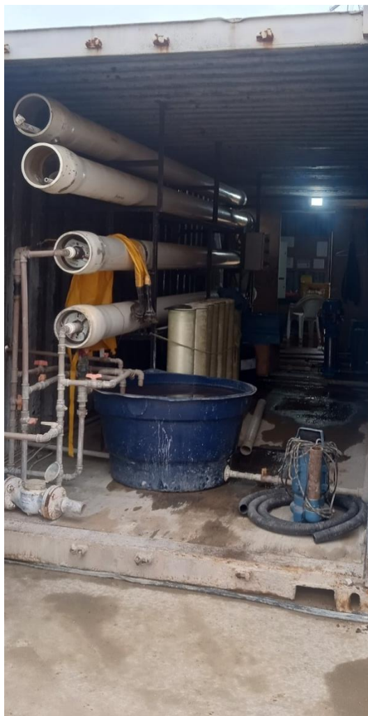
Figura 12 : Equipamento de Osmose reversa para tratamento do chorume
