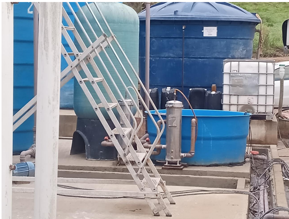
Figura 17: Tanques da Estação de Tratamento e armazenagem .
