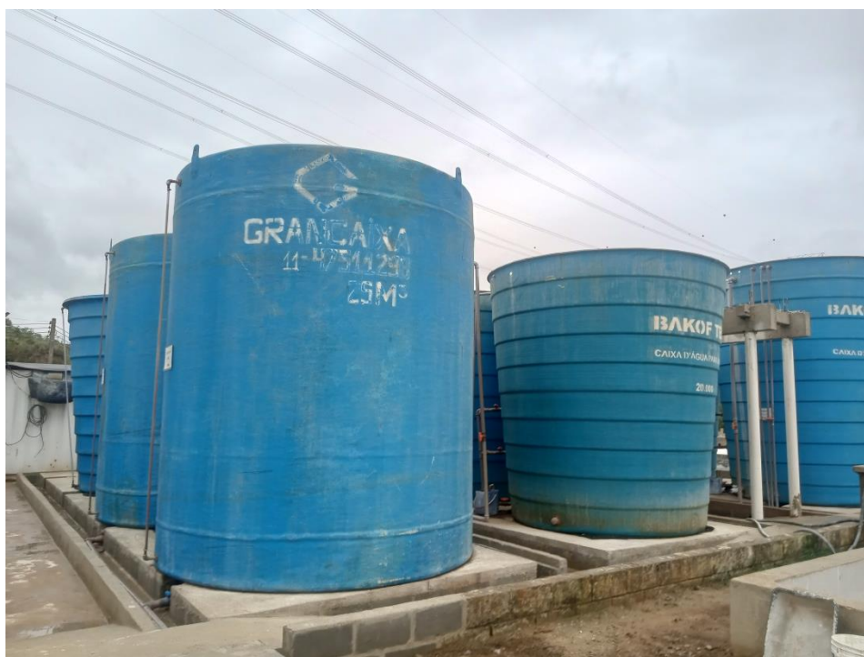
Figura 19: Tanques de armazenagem da estação de tratamento
