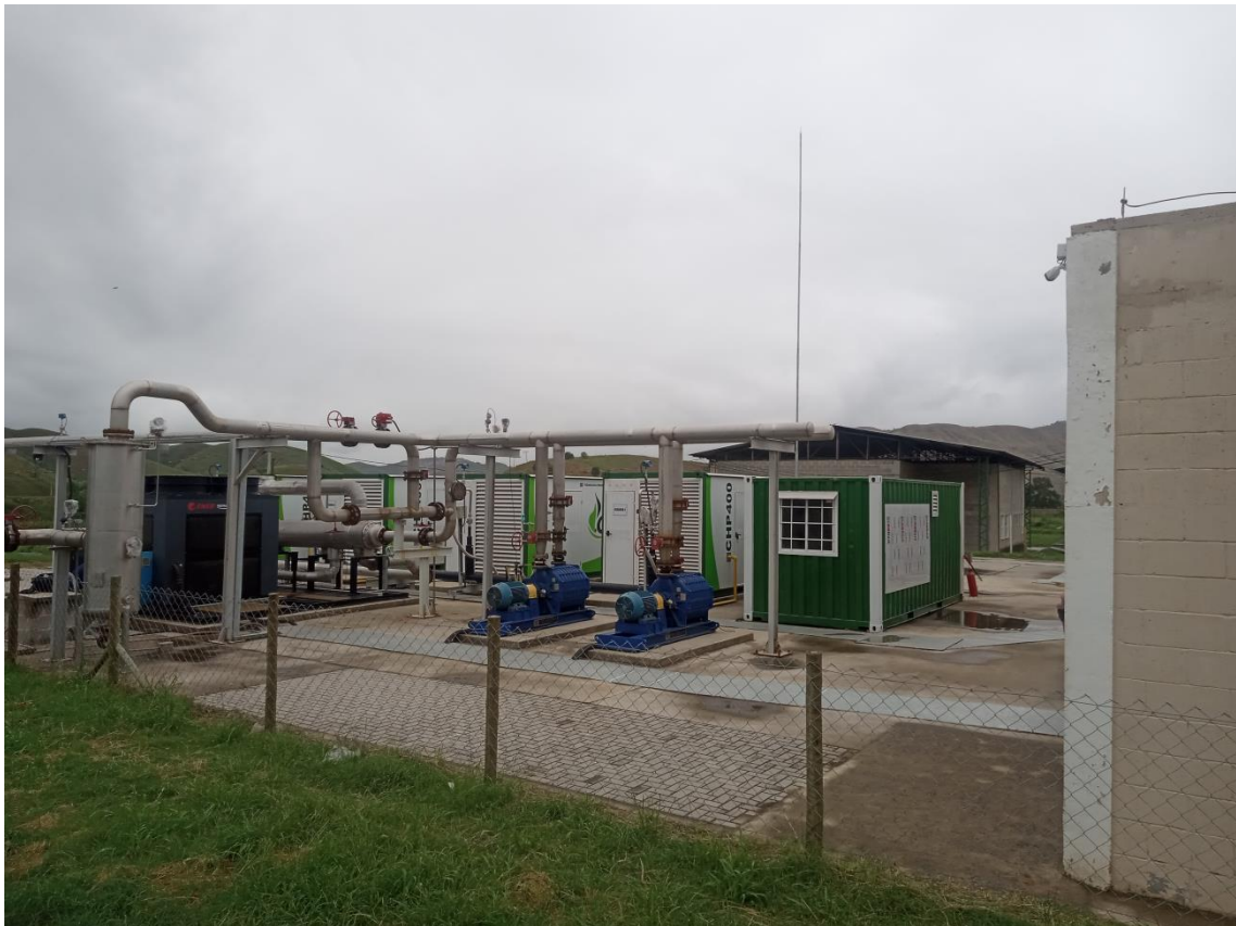
Figura 23: Visão da estação de biogás.
