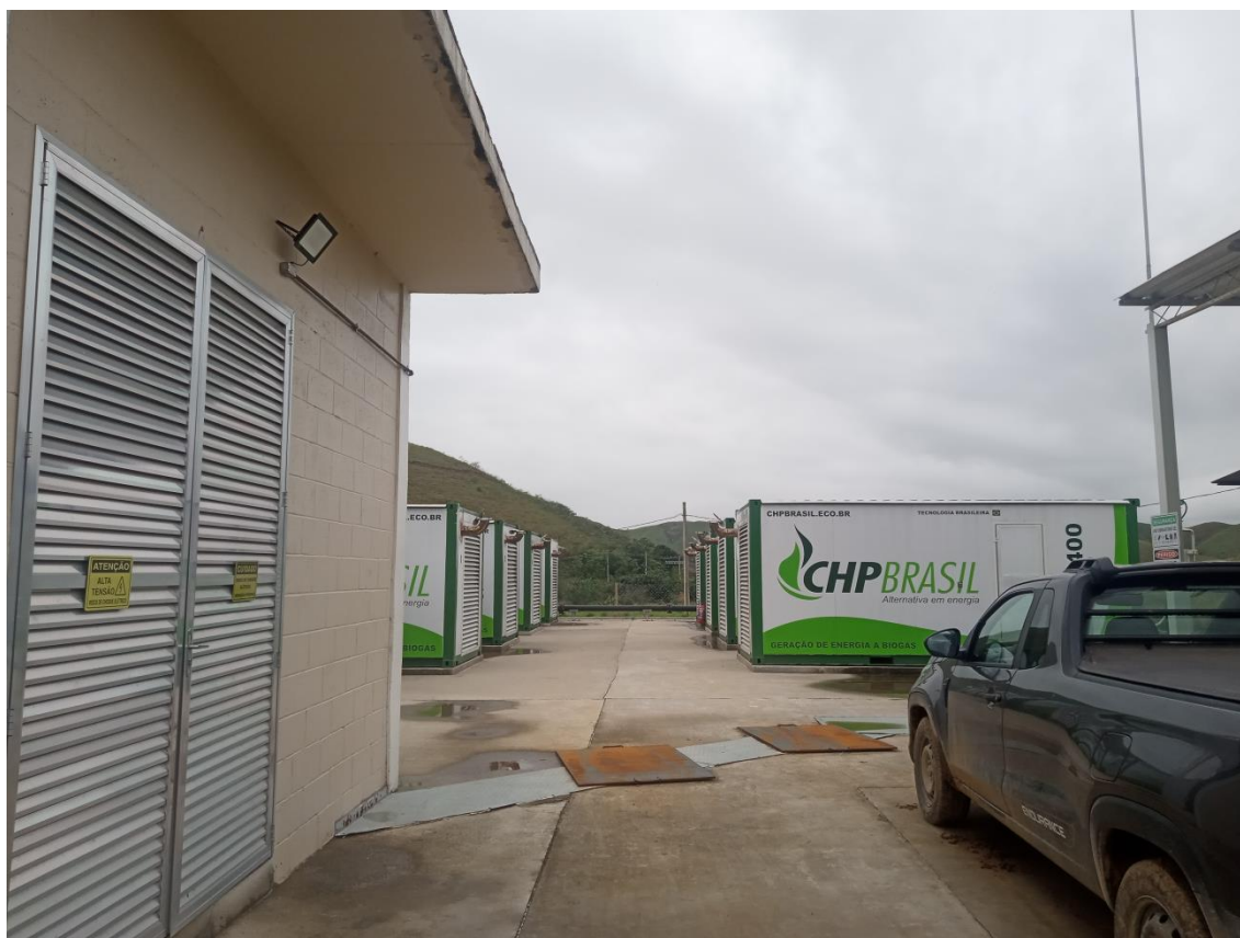
Figura 22: Geradores da estação de biogás.
