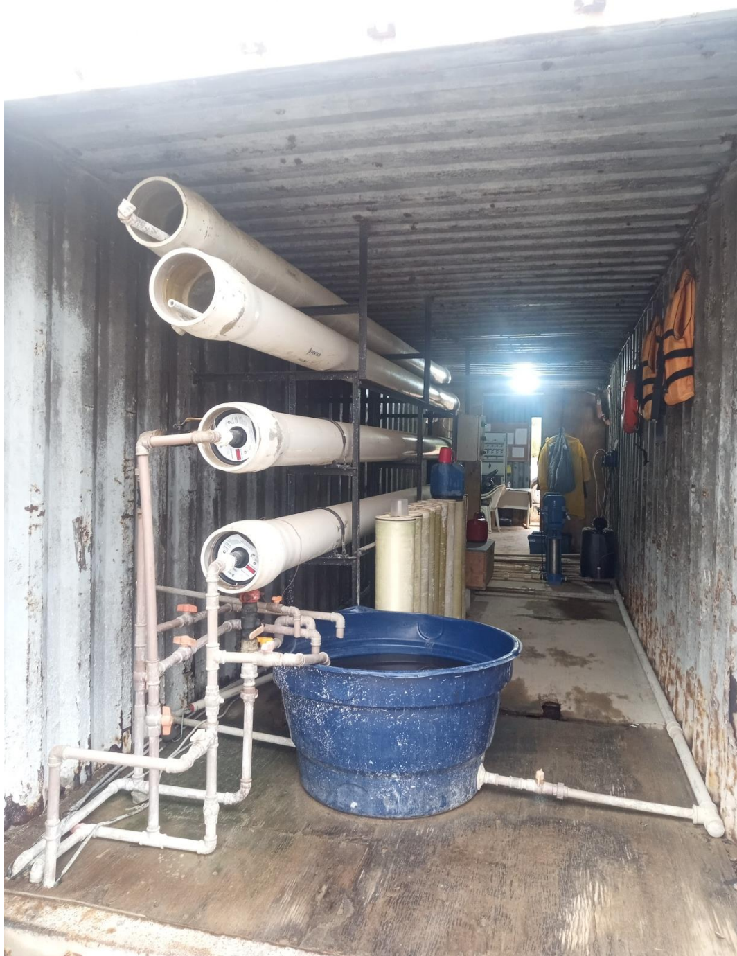
Figura 14: Detalhe da estação de Osmose Reversa
