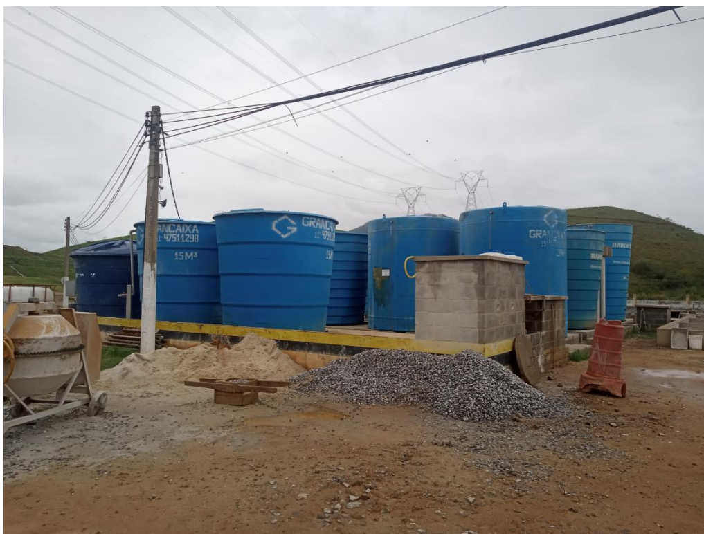
Figura 18: Tanques de armazenagem da estação de tratamento
