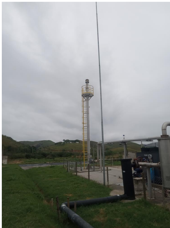
Figura 24: Flare da Estação de Biogás
