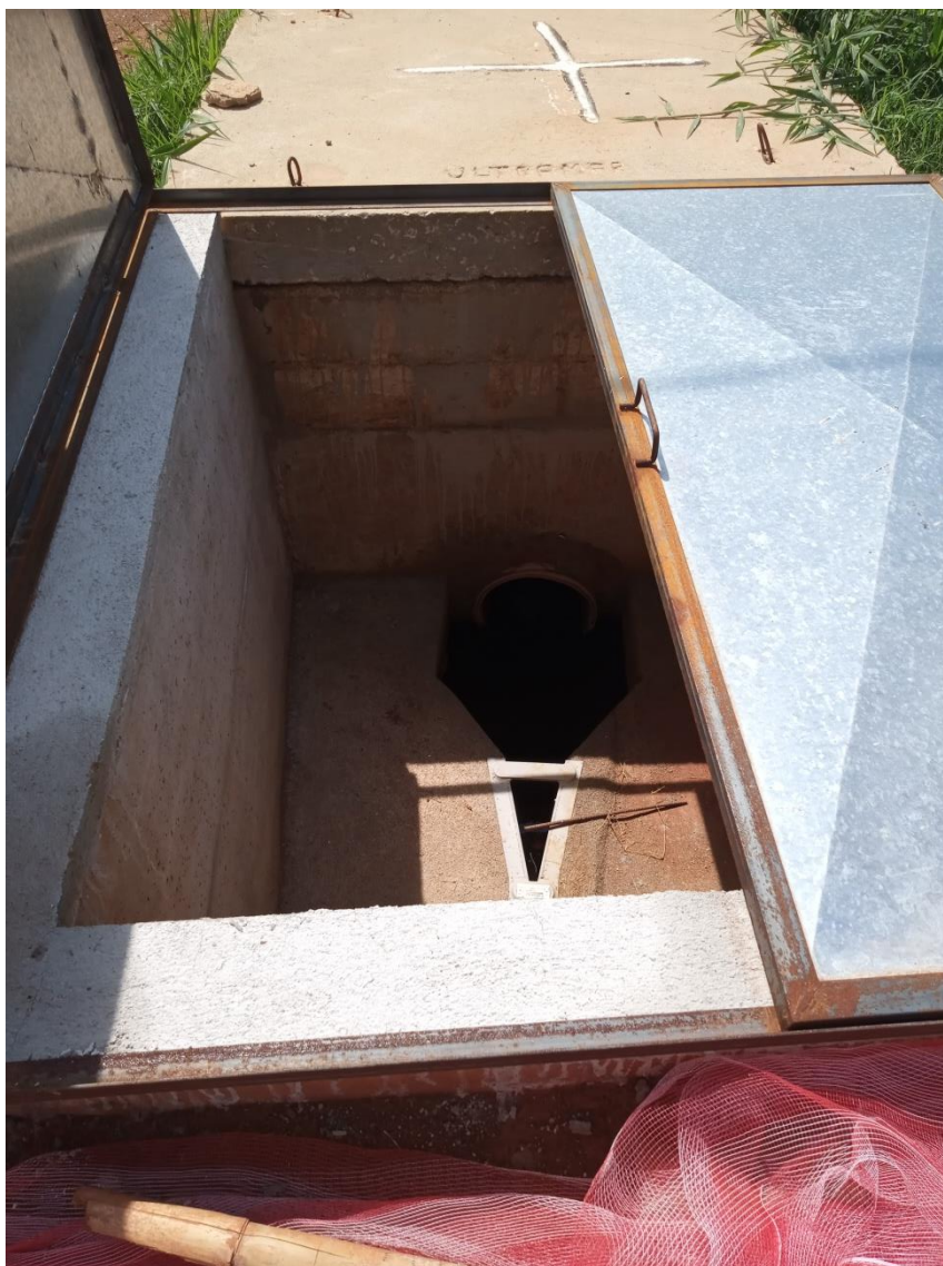
Figura 19: Vista da caixa de passagem do chorume oriundo da célula
