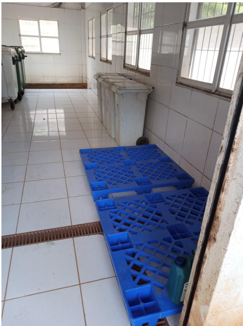
Figura 21: Abrigo temporário de RSS. Onde os resíduos são estocados até serem direcionados para a , empresa contratada para realizar a autoclavagem
