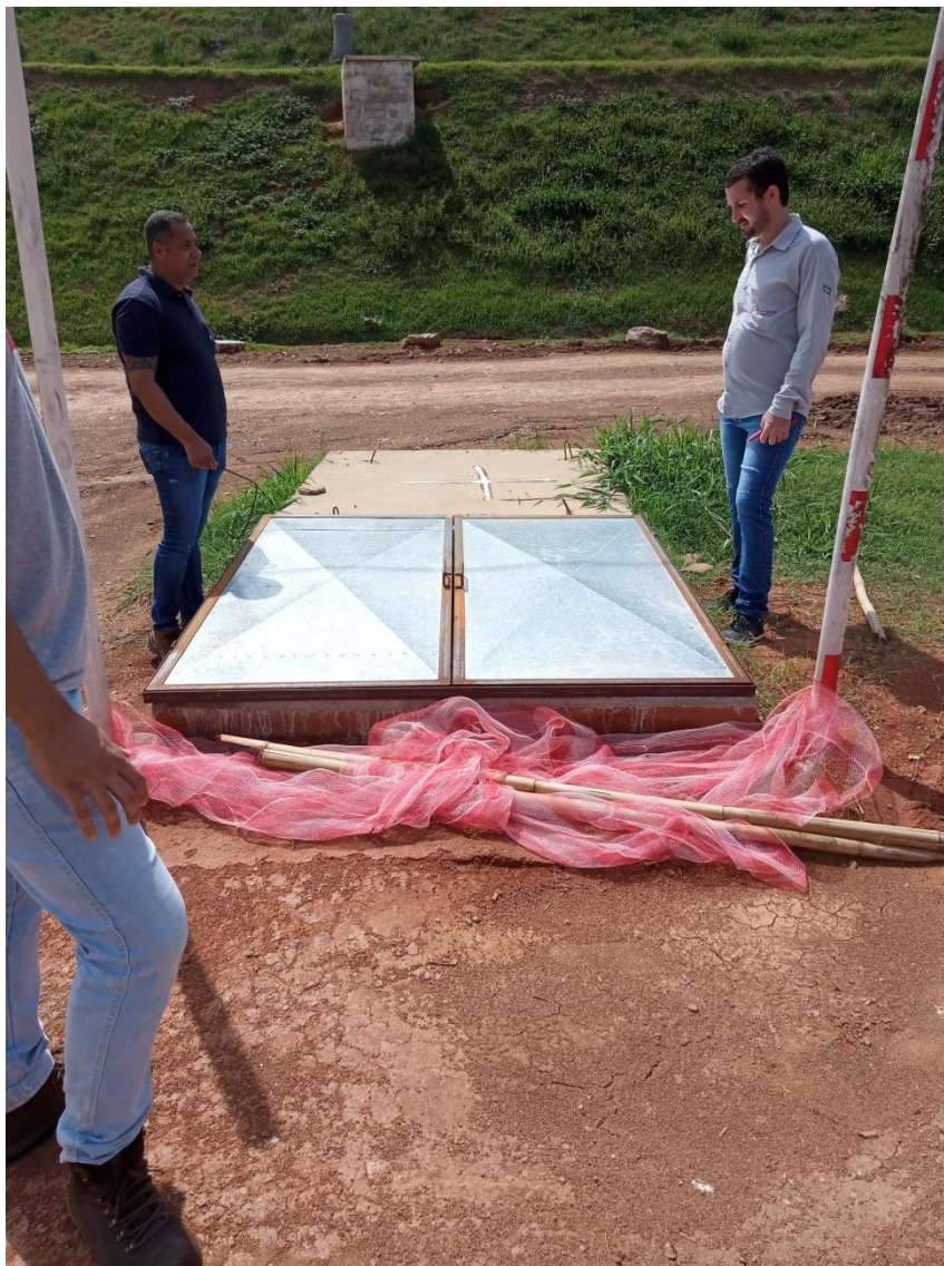
Figura 18: Vista da caixa de passagem do chorume oriundo da célula
