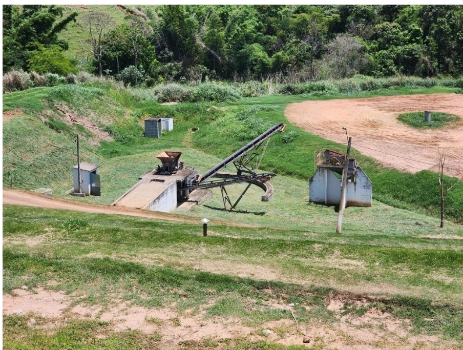
Figura 20: Triturador de resíduos da construção civil
