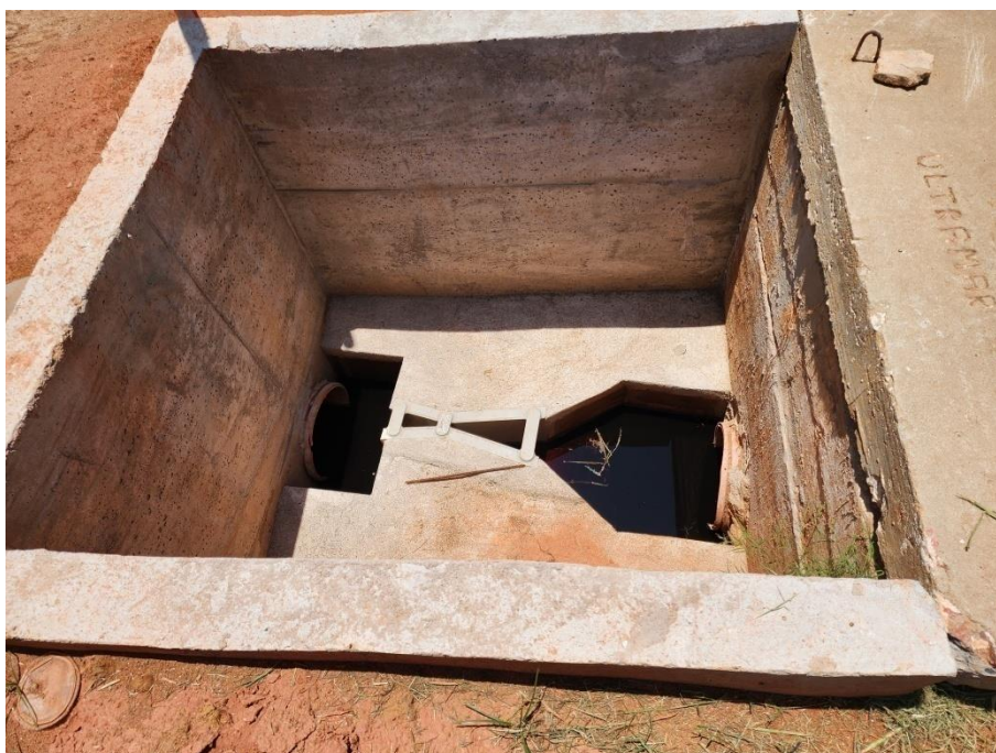
Figura 17: Vista da caixa de passagem do chorume oriundo da célula
