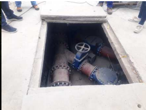
Foto 15 - Poço de Válvulas
