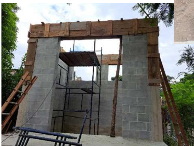
Foto 14 - Sala dos Painéis Elétricos
