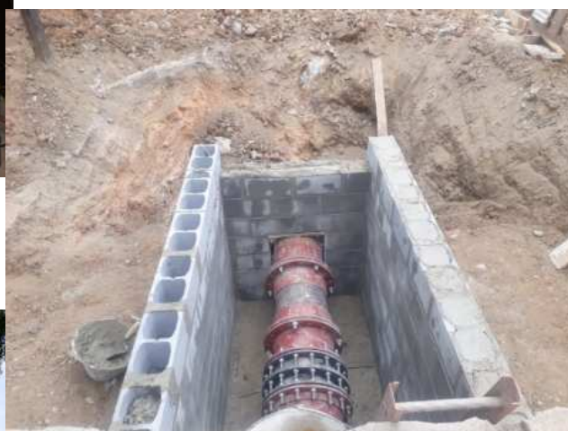
Foto 16 - Tubulação de Recalque da EE
