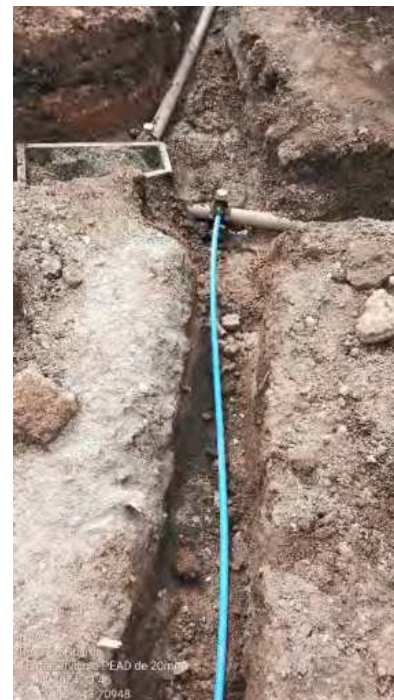
Foto 48 - TE de Serviço e PEAD
