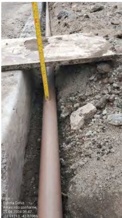
Foto 26 - Altura não conforme
