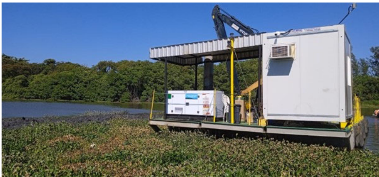
Foto 3 - Balsa flutuante com gerador e container refrigerado
